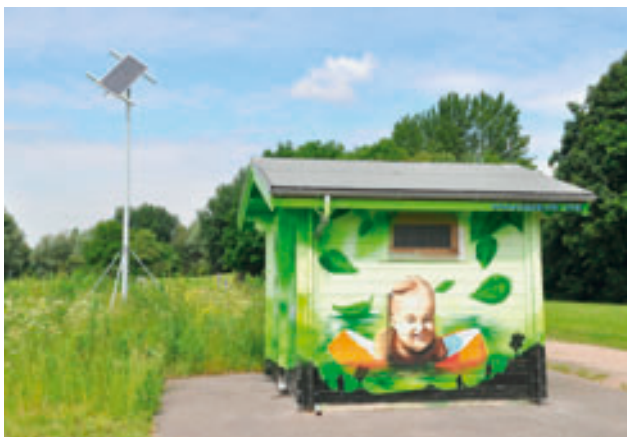
„GreenGain“ an einem Hamburger Badesee. Die WC-Häuschen hängen nicht am öffentlichen Wassernetz. Sie erhalten ihr Spülwasser mittels einer 12-Volt-Pumpe direkt aus dem See. Den notwendigen elektrischen Strom liefert die Solaranlage
