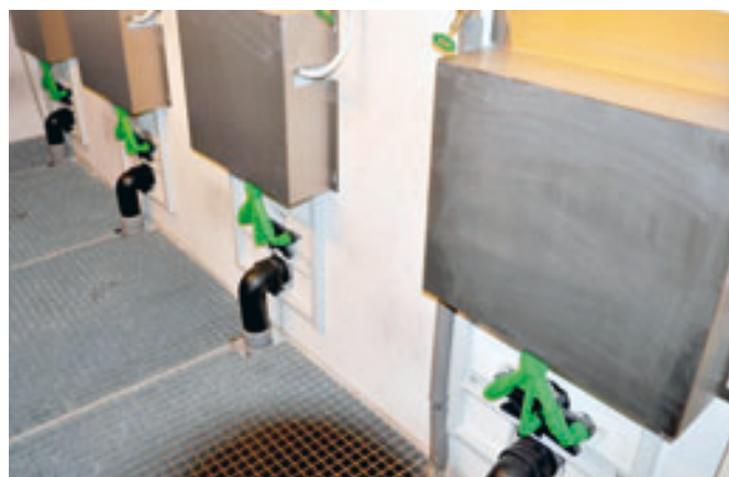
Die Verrohrung des 3,5-Liter-WCs von V&B mit dem Spülkasten geschieht mit Hilfe des „Geweih“. Das trennt das Spülwasser in drei Teilströme auf
