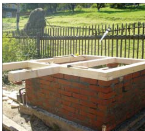
Фиг. 5: Рамка за пода на тоалетната (ляво) и изрязване на отвор за тоалетната чиния (дясно)
