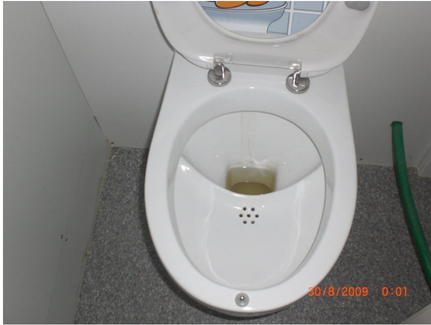
Figure 2.1: Urine diverting (UD) toilet
