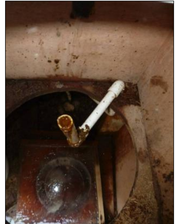
MOVE FOTO T3: Yon tiyo pipi ke yo detache, pipi a ap koule atè nan chanm twalèt la, nan yon twalèt UD SOIL.
