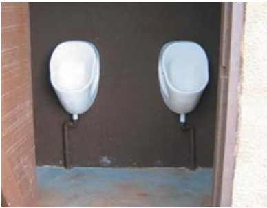
Le bloc d'urinoir public construit en Côte d'Ivoire comprend deux cabines équipées de deux cuvettes chacune. L'urine des quatre cuvettes est canalisée vers un bidon de 20 l de capacité placé dans un regard fermé.
