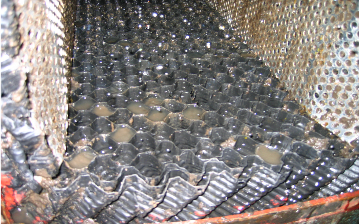
Abbildung 7.34: Kunststofffüllmaterial im mittleren Tropfkörperbereich (ca. 0,75 m über dem Gitterrost) des halbtechnischen Tropfkörpers bei ca. 0,98 kg BSB 5 /(m 3 ·d) am 16.11.2006
