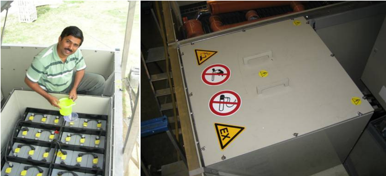
Bild 3: Die Batterien im luftdicht abgeschlossenen Behälter
