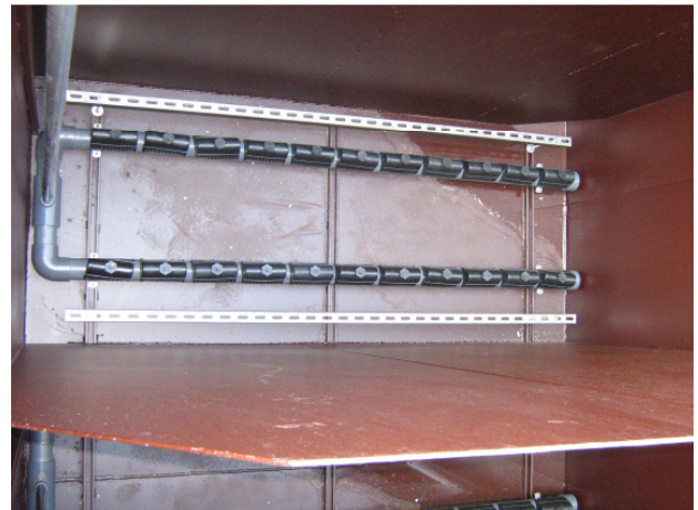
Bild 4. Blick auf das Belüftersystem in einer Reaktorkammer vor der Befüllung mit den Festbett-Füllkörpern
