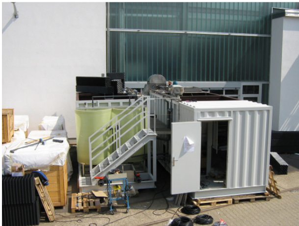
Bild 3. Gesamtansicht der Containerkombination auf dem Betriebsgelände der 2H-Kunststoff
