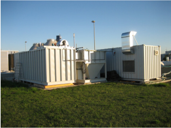
Bild 9.: Gesamtansicht der Containeranlage. Hinten: Messcontainer der MLU. Die beiden Container im Vordergrund zeigen die Rückseite der 2H-Versuchsanlage
