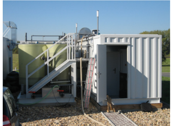
Bild 10.: Ansicht der 2H-Containeranlage von der Vorderseite (Eingangsseite zum Schaltraum)
