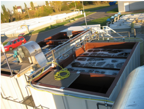
Bild 11.: Sicht auf die Containeranlage. Im vorderen Behälter sind die drei Nitrifikationskaskaden zu erkennen.
