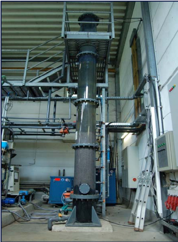
Bild 10: Rückspülbare Schnellfiltration auf der Versuchsanlage Düsseldorf
