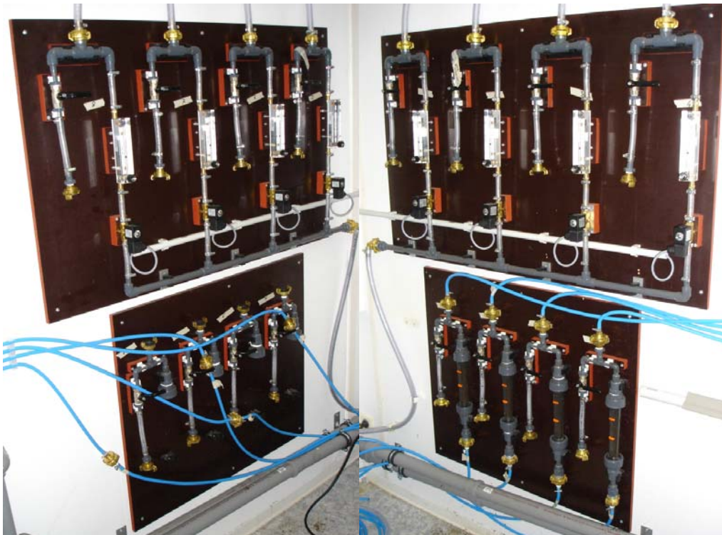
Anlagenperipherie: Luft- und Wasserverteilung
