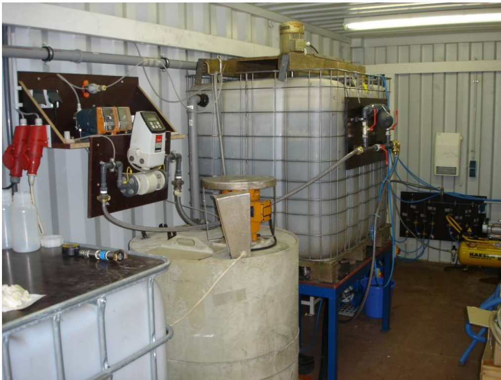
Anlagenperipherie: Puffer- und Mischbehälter, Harnstofftank, Dosierstation
