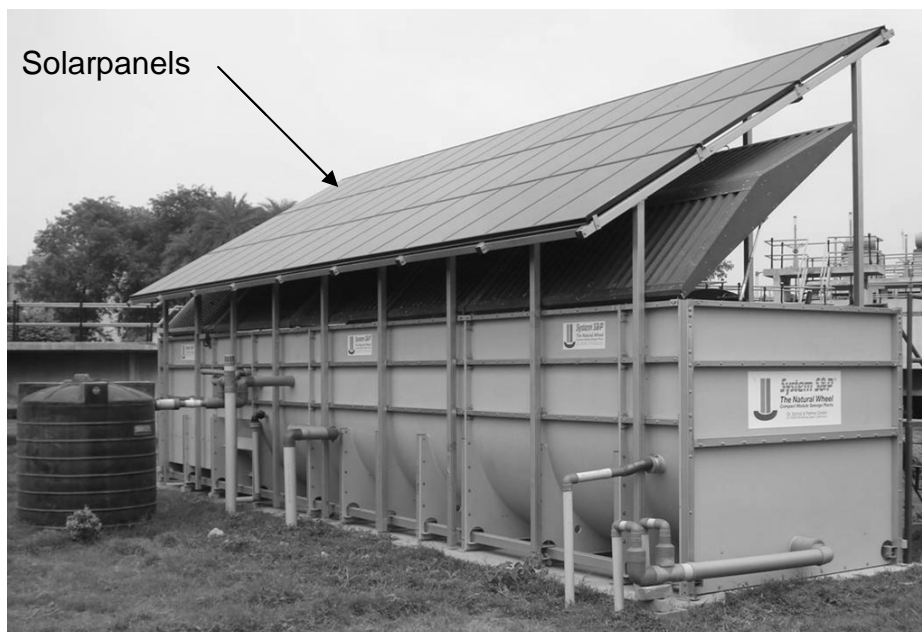
Bild 2.6: Die Demonstrationsanlage auf der Yamuna Vihar Kläranlage in Delhi, Indien
