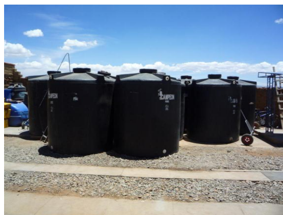
Fig. 7: Almacenamiento de orina en tanques plásticos de 5,000 L de capacidad en la planta de compostaje (Andersson, 2011).
