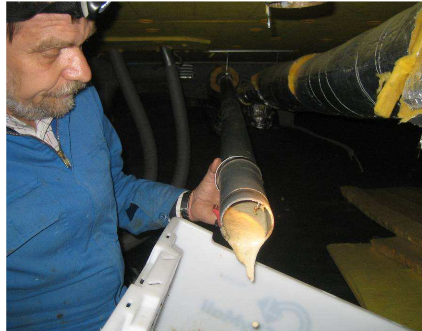
수평 도관의 찌꺼기가 흘러 나옴, Kullön, Sweden, 2006. Photo: A. Richert Stintzing
