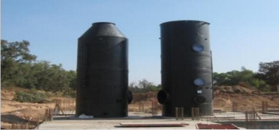
Tours de désodorisation – Station relevage Souss
