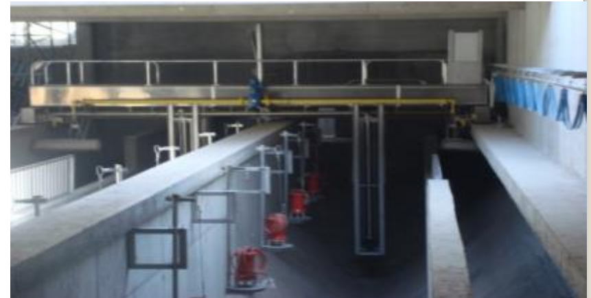
Dégreaisseur-dessableur Station Sous
