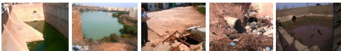
Figure 19 : Différents formes de dysfonctionnement des bassins de rétention des eaux pluviales à l'exemple de Casablanca 152
