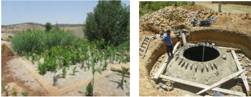
Figure 12 : Filtre planté et digesteur à Dayet Ifrah 104
