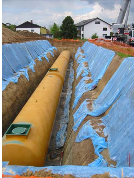
Bild 3: Zisternen zur Speicherung des Regenwassers
