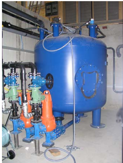
Bild 4: Vakuumstation im Wasserhaus
