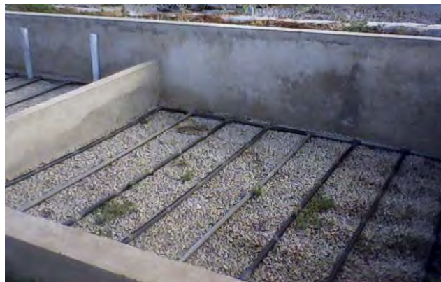
Figure 27 : Filtres à écoulement vertical du troisième étage
