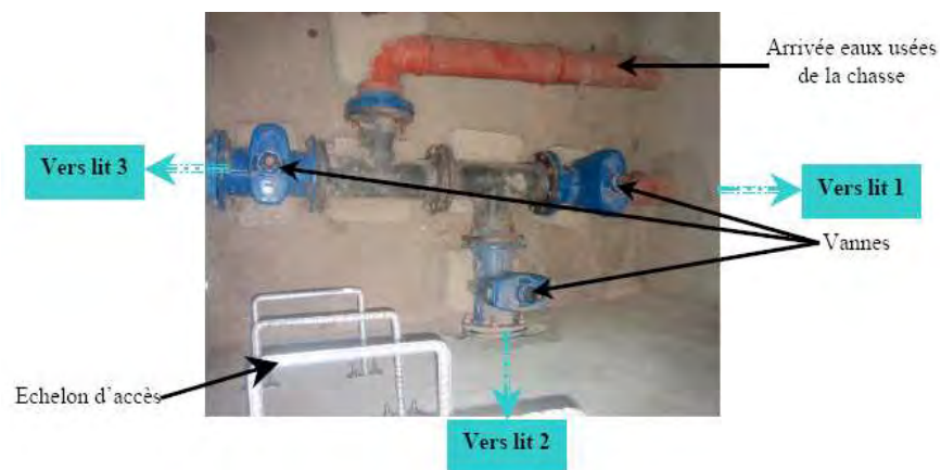
Figure 15 : La chambre des vannes
