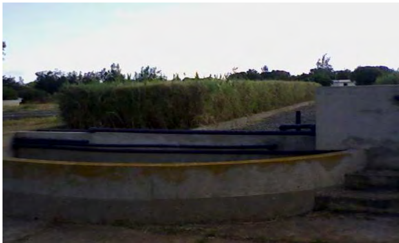
Figure 26 : Bassins des filtres à écoulement horizontal du deuxième étage
