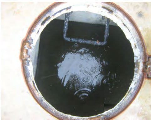
Figure 36 : Le niveau dans la bêche atteignant trop plein
