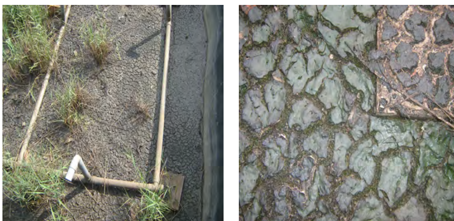
Figure 42 : Couche à la surface des filtres empêchant l'infiltration (02/15/2009)
