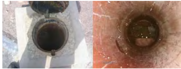
Figure 20 : Puisards à la sortie des lits
