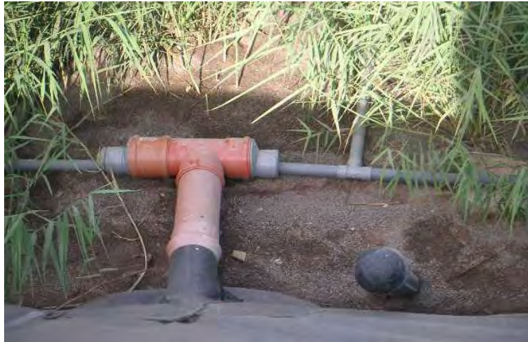
Figure 18 : Canalisation de distribution des eaux usées
