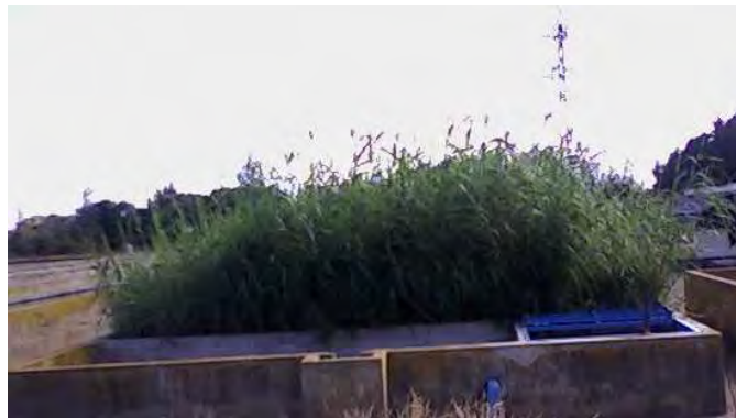
Figure 25 : Filtre à écoulement vertical du premier étage
