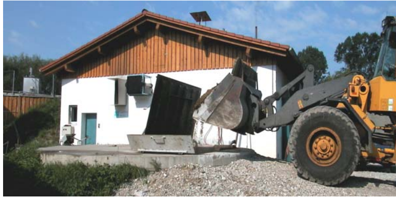
Abb. 32: Vorgrube zur Sammlung und Homogenisierung von Substraten
