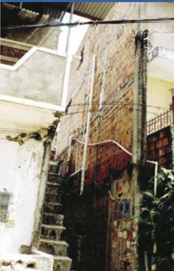
Tubería de alcantarillado adjunta a la pared, Sao Caetano, Salvador de Bahía
