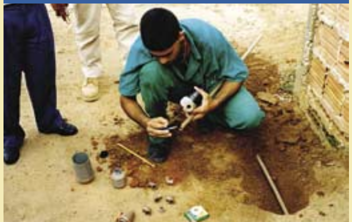
Ilustración de micromedidores en una conexión domiciliaria, Parauapebas
