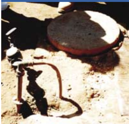
Micromedidor y caja condominial, Brasilia
