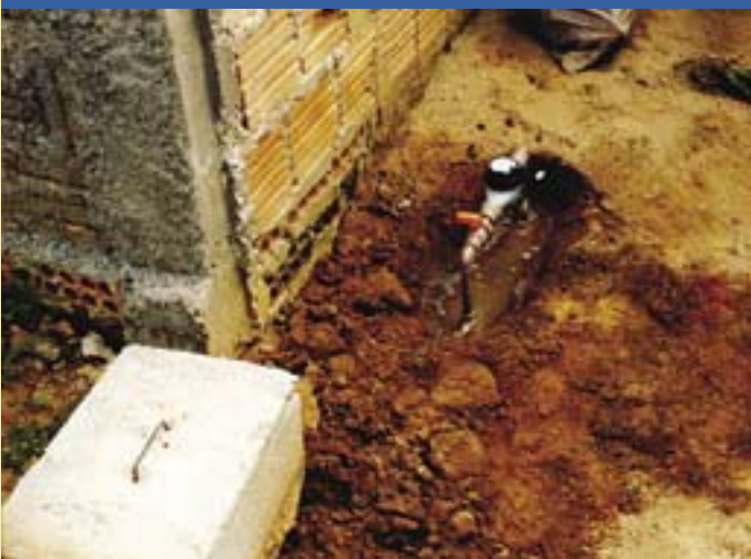
Medidor doméstico instalado, Parauapebas
