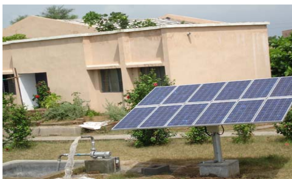
Abbildung 18 Solarkollektor und Wasserpumpe
