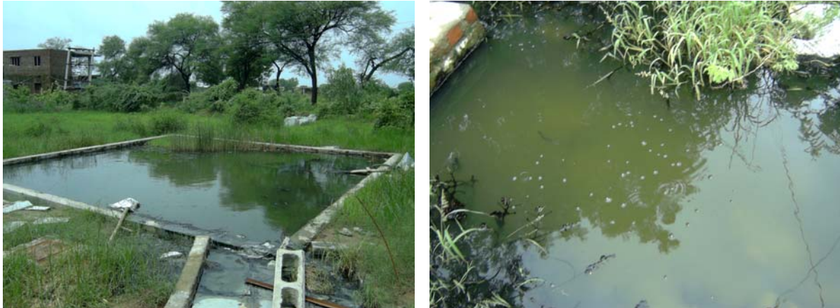
Abbildung 11 Überstaute Sickergrube mit aufsteigenden Gasblasen
