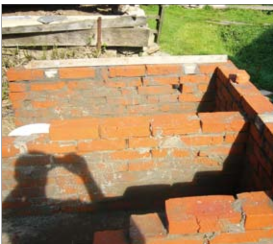
fig. 4: Construirea din cărămizi a unui compartiment pentru fecale exterior pereților (stânga), gaură pentru conducta de urină (dreapta)
