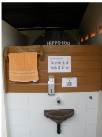
Abb. 17 Handwaschbecken aus Terrazzo mit Seifenspender. Das Selbstschlussventil ist am Regenwassertank angeschlossen.
