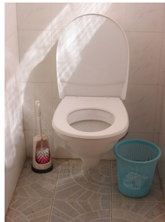
Abb. 02 Wandhängende Wasserspartoilette mit aufgesetztem Keramik-Spülkasten
