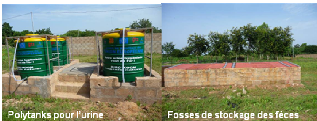
Figure 14: Quelques infrastructures du site d'hygiénisation
