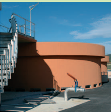
Au premier plan, la cuve du lombrifiltre, suffisante pour 1.200 habitants
