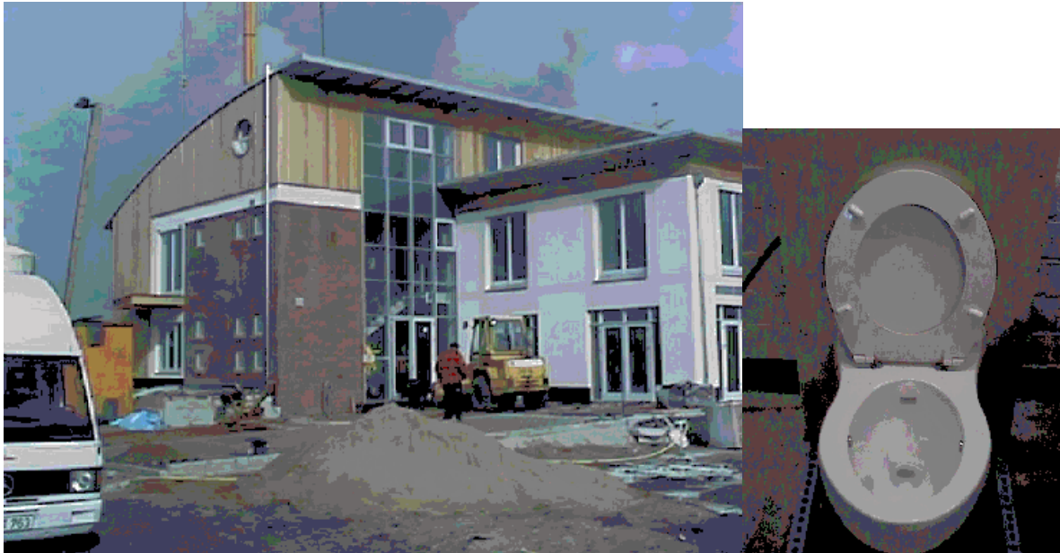
Fig.9.4 (left) Le bâtiment commun dans l'agglomération de Flintenbreite; (right) Un WC – vaccum utilisant un litre d'eau.
