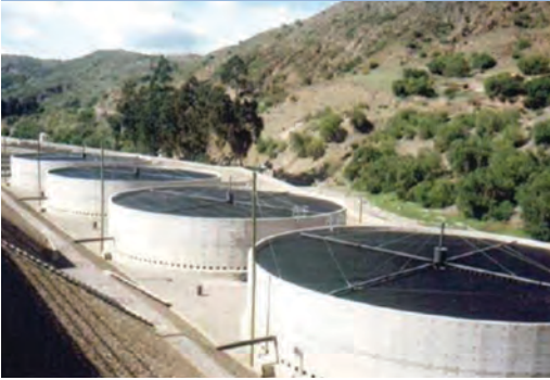
Figura 29: Filtros percoladores en Sucre
