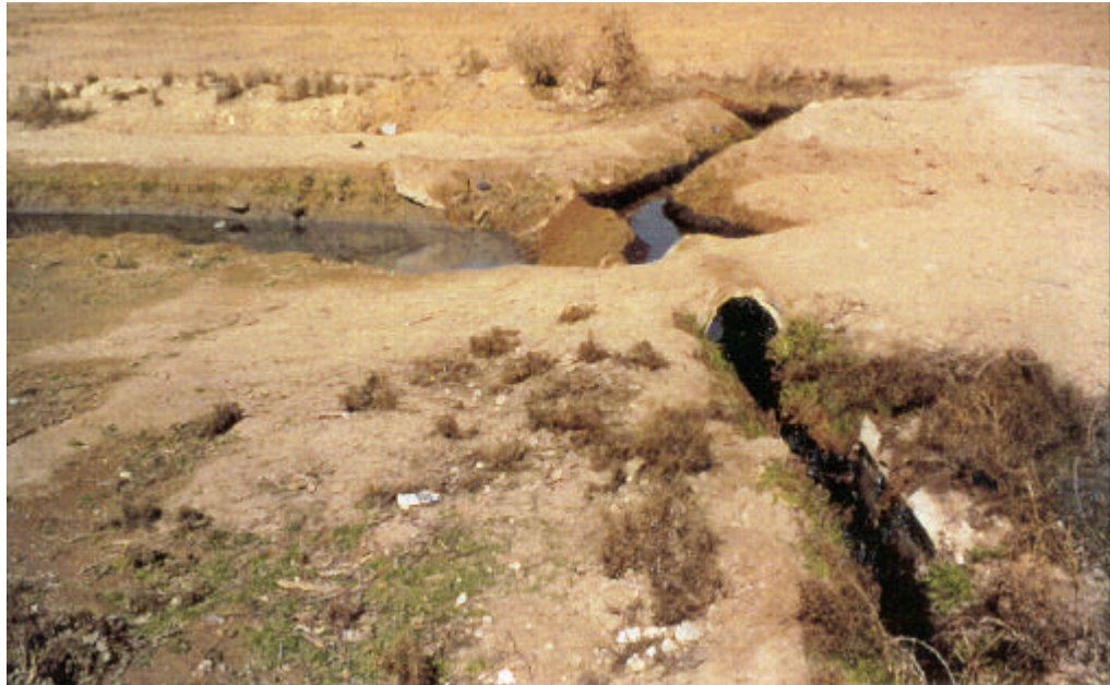
Abb. 8: Absichtlich hergestellter Bruch im Abwasserentsorgungskanal (eigenes Foto)
