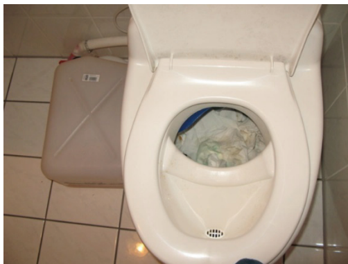
Figura 2: Baño seco con separación de orina
