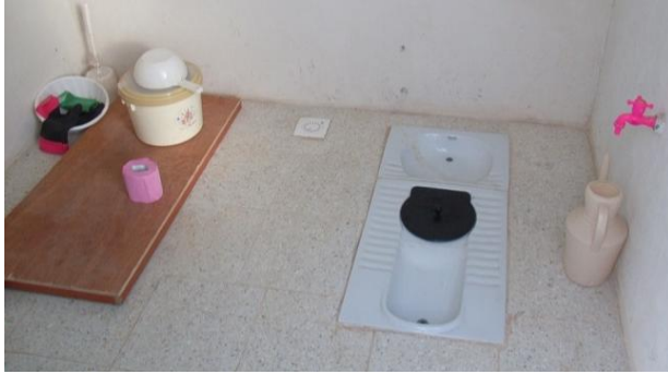
Figure 2: Cuvette à séparation d'urine d'une double TDSU dans une maison à Herat, Afghanistan. Le pan en bois à gauche couvre la deuxième cuvette situé sur le second orifice de défécation (source: N. Khawaja, 2010).
