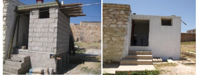
Figure 6: Vue d'une TDSU à Dayet Ifrah, durant la construction (à gauche), Maroc. La toilette contient une douche et est accolée à la maison (source: GIZ/AGIRE, 2010).
