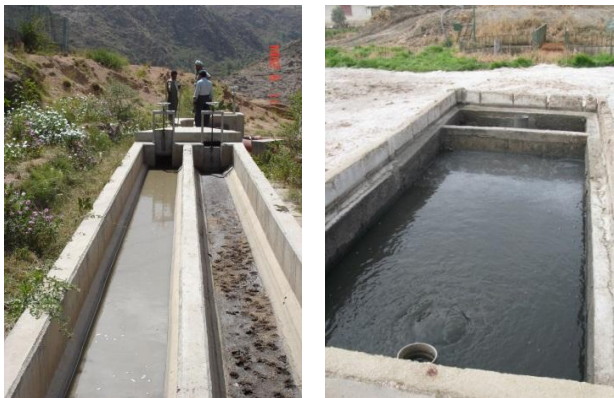
Figure 3: A gauche: Canal dessableur à la station de la ville de Hajja, Yemen (à gauche: canal en fonctionnement; à droite: canal mis en repos avec sable accumulé en séchage avant évacuation) (source: El Hamouri, 2004). A droite: Canal de dessablage en amont d'un filtre planté à Haran-Al-Awamied près de Damas, Syrie (source: E. von Muench, 2009).
