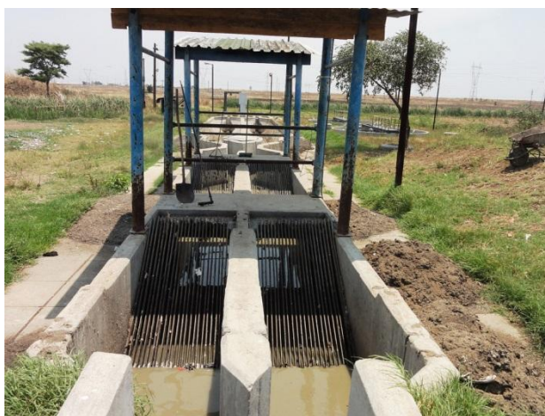
Figure 1: Unité de dégrillage installée dans une station de traitement à Norton, Zimbabwe (source: P. Feiereisen, 2011).
