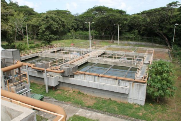
Figure 2: Avant plan: Réacteur UASB de 15.000 EH pour le traitement des eaux usées domestiques. Arrière plan: lits de séchage des boues. Localité de San Juan del Sur, Nicaragua (source: PROATAS/GIZ – AKUT).
