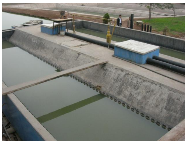
Figure 5: Vue en plan de l'UASB de la figure 4 montrant la surface de l'ouvrage avec au centre le séparateur de phase et la collecte du biogaz ainsi que les déversoirs d'évacuation de l'effluent situés de part et d'autre en longueur. Arrière plan: bassins de post-traitement (source: LeAF, 2010).
