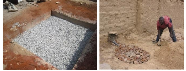
Figure 3: A gauche: Puits d'infiltration pour les eaux de lavage anal d'une TDSU au centre d'éducation Darad dans le Ukunda communauté côtière, Kenya (source: S. Miethig, 2011). A droite: Puits d'infiltration circulaire pour eaux grises en construction au Mali (source: J. O'Keeffe, 2011).
