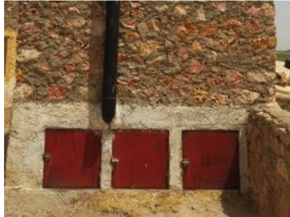
Chambre de déshydratation
