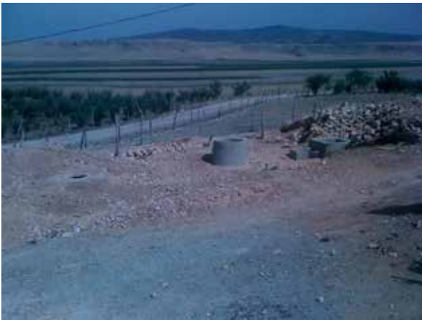
Image 479 : Vue globale du digesteur finalisé.
