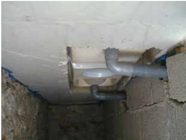
Image 346 : Vue de la tuyauterie dans la fosse gauche.
