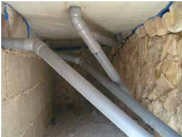
Image 348 : Vue de la tuyauterie dans la fosse droite.
