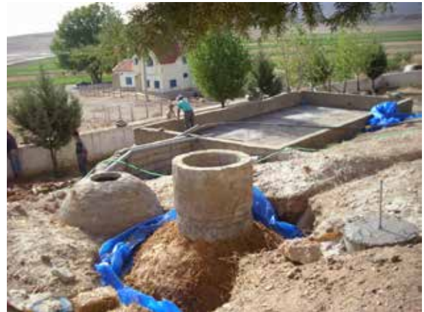
Image 565 : La conduite du digesteur au filtre est posée. La chambre de visite à la sortie est faite.
