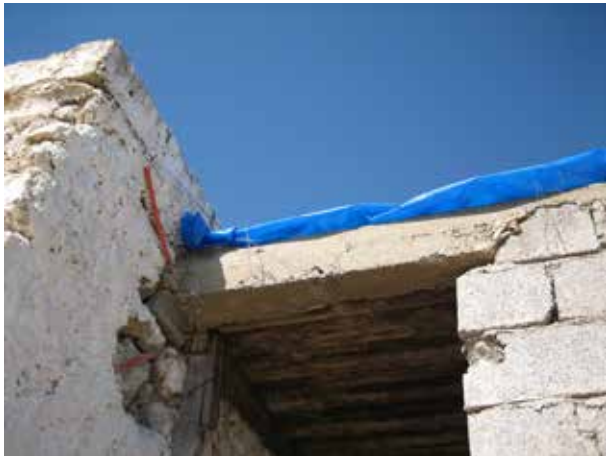
Image 166 : Le linteau a été coulé ensemble avec le toit.
