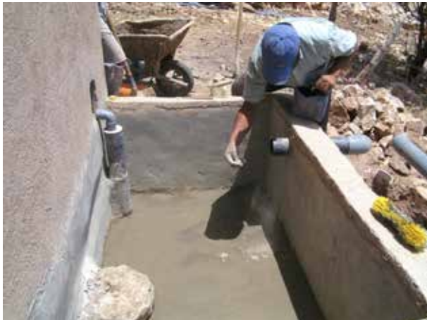
Image 121 : Directement après l'application des enduits on peut fermer des fissures avec du ciment pur et un peu d'eau.
