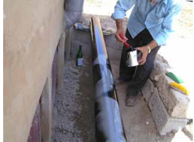
Image 176 : La peinture noire sur le tuyau de ventilation cause un chauffage solaire augmenté, ce qui supporte le courant d'air.
