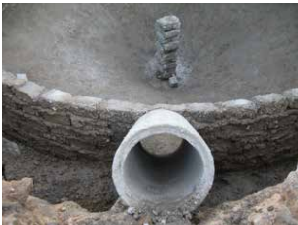
Image 406 : Vue de la buse du bassin d'expansion et du centre du digesteur.
