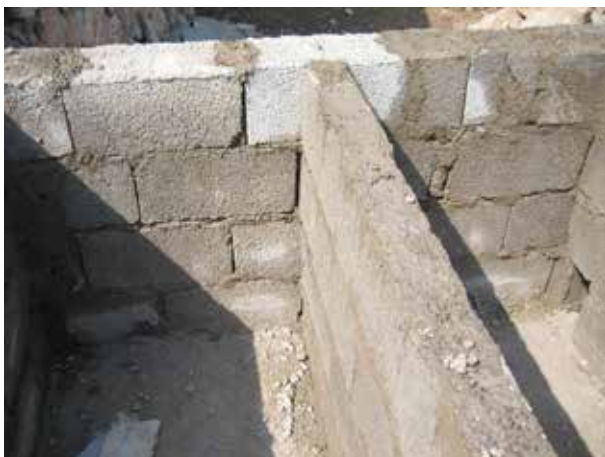
Image 238 : Le mur intérieur qui sépare les deux fosses. A droite on voit le trou pour la sortie de la tuyauterie.
