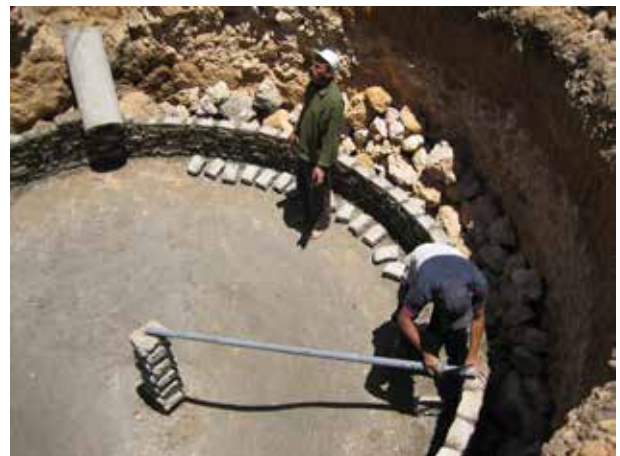
Image 401 : La brique est placée à l'aide de la baguette de mesure. La baguette est à la perpendiculaire de la longueur de la brique. Le dessus de la brique est toujours parallèle à la baguette.
