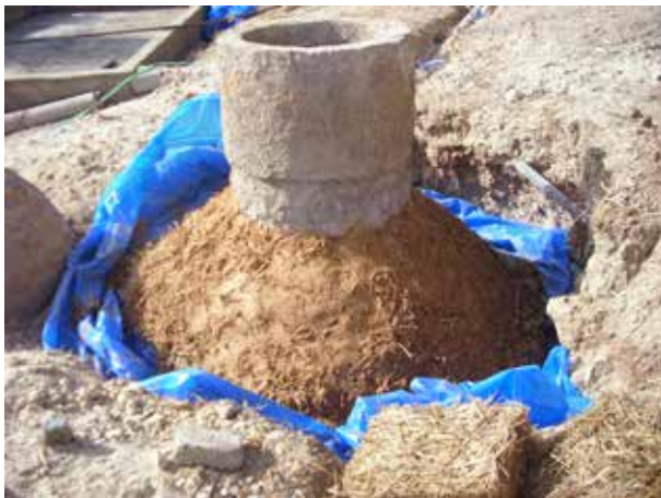
Image 527 : Une couche isolante d'argile et de paille est posée sur la surface extérieure du digesteur.
