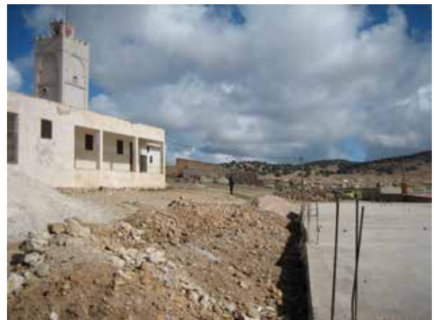
Image 482 : La mosquée centrale de Dayet Ifrah dont les eaux usées seront aussi épurées dans le filtre planté.
