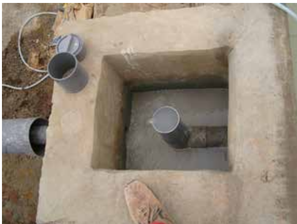
Image 582 : Chambre de visite à la sortie des eaux épurées. En changeant la position (l'angle) du tuyau vertical le niveau d'eau dans le filtre peut être ajusté.
