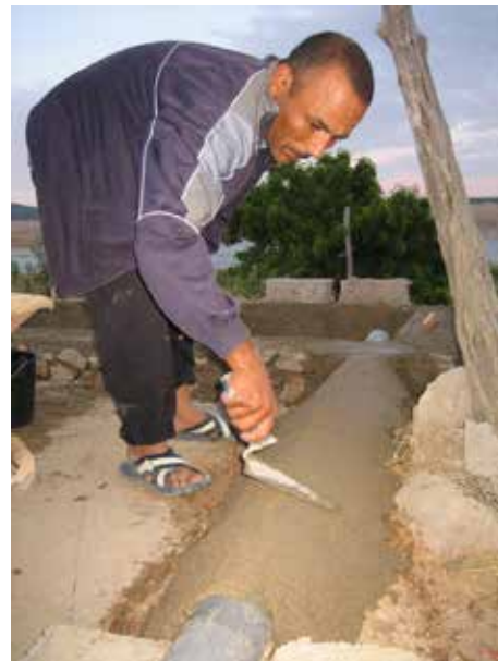
Image 190 : Une couche de mortier au-dessus du tuyau donne la stabilité et fixation nécessaire.
