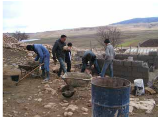
Image 27 : Préparation du mortier dans une brouette et collecte de pierres pour l'escalier.
