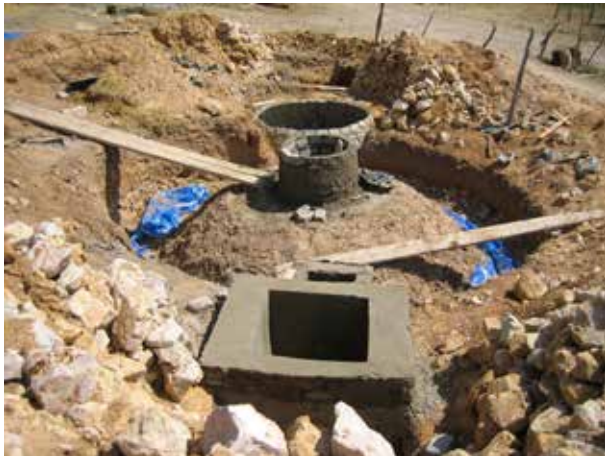
Image 456 : Le chantier pendant la construction de la couronne de couvercle et du bassin d'expansion.
