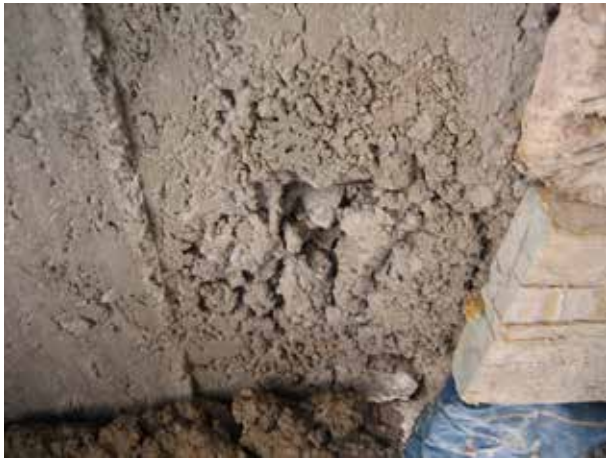
Image 68 : Cavités et fissures dans le béton du toit.
