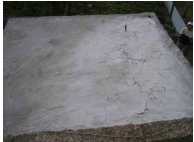
Image 173 : Fissures dans la superficie du toit.
