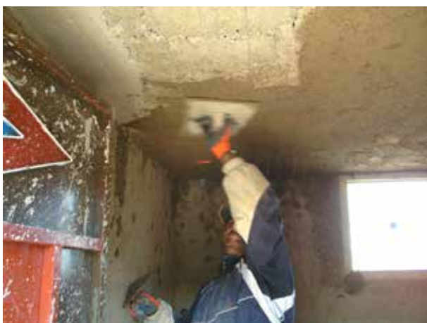
Image 72 : Application d'une couche d'enduits à la partie inférieure du toit. La porte est déjà installée.
