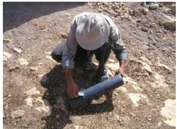
Image 290 : Application de la colle PVC et du sable sur le tuyau de l'effluent.
