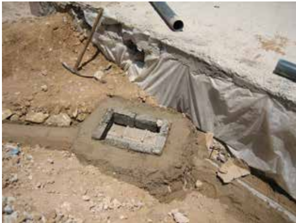
Image 489 : Chambre de visite coffrée (à l'angle de 2 conduites).
