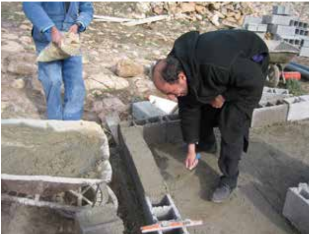
Image 26 : Les briques ont été remplies de cailloux et mortier pour fortifier les murs des fosses.
