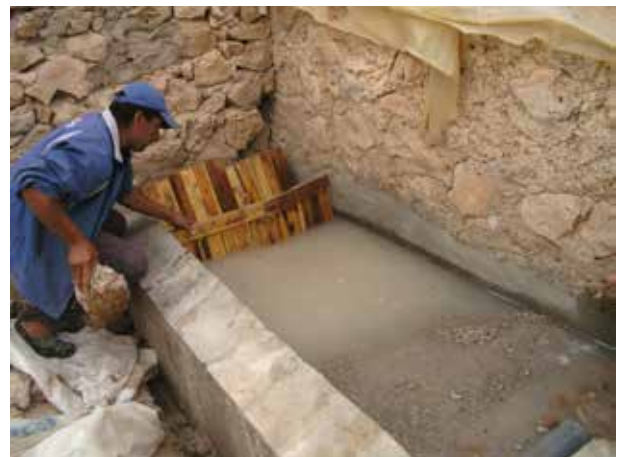
Image 371 : Avec des planches à la zone de l'entrée, les 3 différentes tailles du grain sont séparées pendant le placement du matériau de filtre.
