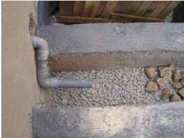
Image 125 : La conduite des eaux de nettoyage anal est branchée au compartiment d'infiltration. La couche de gravier concassé sera finalement entièrement couverte par des pierres plus grosses.
