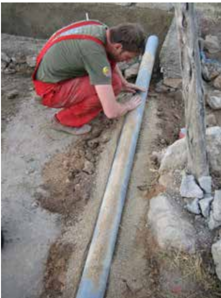
Image 189 : La conduite des eaux grises passe à la superficie. Elle est placée sur une couche de sable et ciment.
