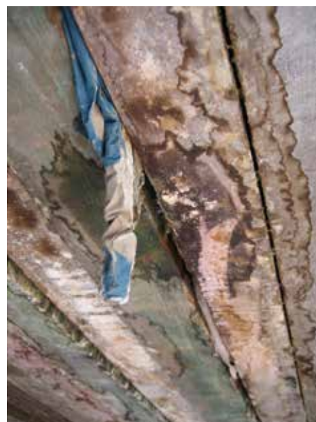
Image 165 : Au lieu d'un plastique les maçons ont utilisé des emballages du ciment pour étancher. Par conséquent, il y avait quelques pertes de la partie liquide du béton.
