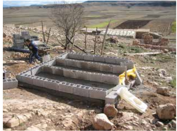
Image 25 : Les fosses ont trois compartiments (deux pour la matière fécale et une pour la sortie de la tuyauterie et le stockage d'accessoires).
