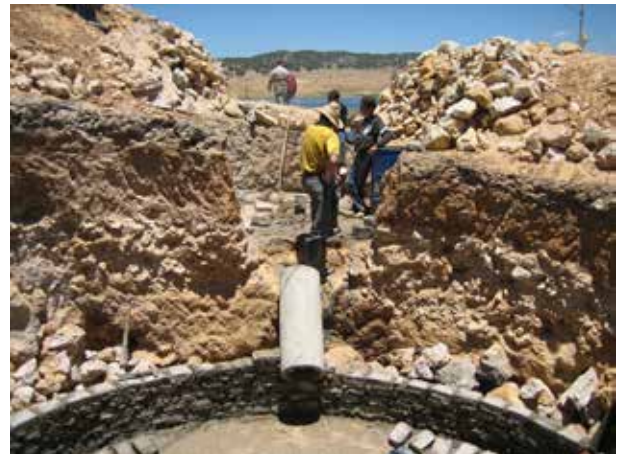
Image 395 : Vue de la buse du bassin d'expansion. La buse est fixée par un piquet au centre du bassin d'expansion.
