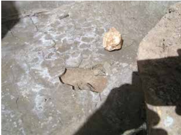
Image 119 : Fissures dans une mauvaise couche d'enduits sans sable et avec trop de SikaLite.
