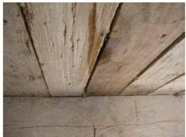
Image 67 : Problèmes d'étanchéité du toit.
