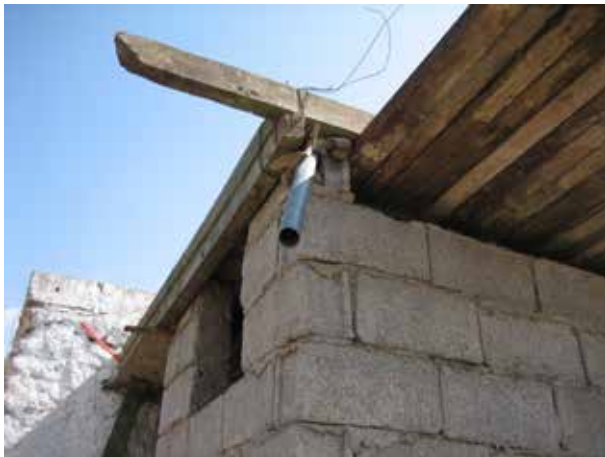
Image 162 : Tuyau pour l'évacuation des eaux de pluie.
