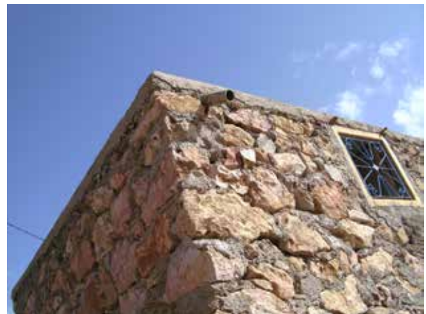
Image 334 : Vue de la superstructure après enlever le coffrage et installer la fenêtre. Le tuyau sert à l'évacuation des eaux de pluie.
