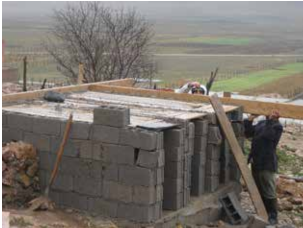
Image 32 : Préparation du coffrage pour la dalle, supporté par des briques positionnées à l'intérieur des fosses.
