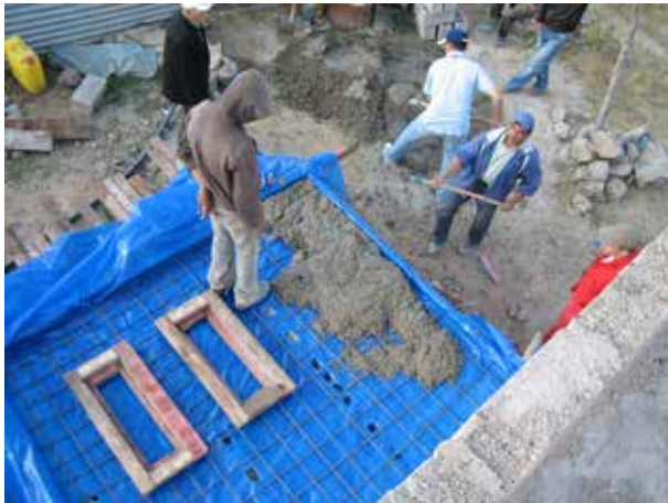
Image 145 : Distribution du béton. Des trous dans le plastique assurent la liaison de la dalle avec les murs des fosses.
