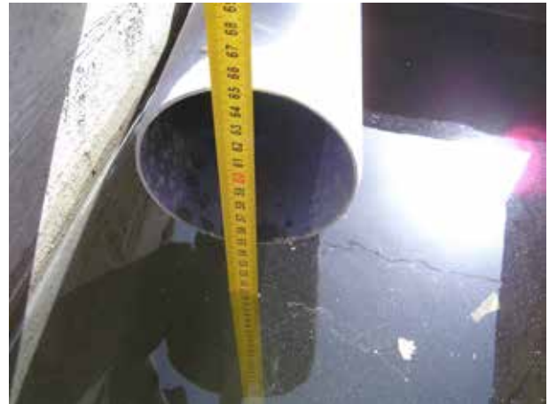
Image 223 : Le niveau de l'entrée est de 5 cm au-dessus du niveau d'eau.
