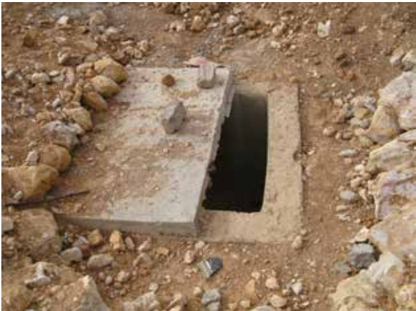
Image 468 : Ouverture pour la vidange des effluents digérées.
