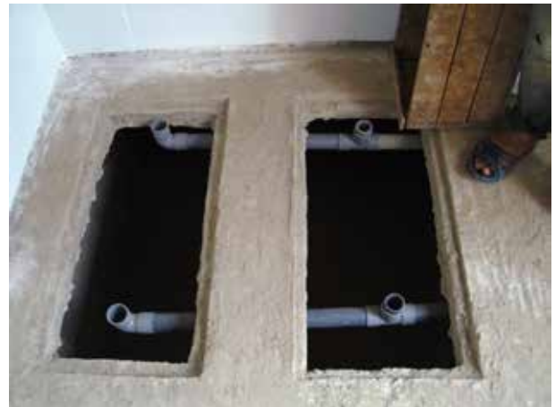
Image 178 : Les deux refoulements pour les sièges de toilette. Les tubes à l'avant seront pour l'urine, et ceux en arrière pour les eaux de nettoyage anal.
