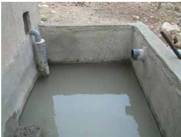
Image 123 : Un test d'étanchéité montre qu'il y a encore une perte d'eau.
