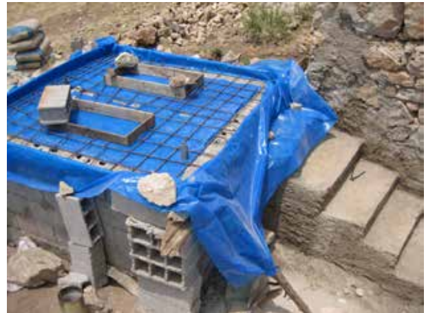
Image 251 : Coffrage et ferrailage sont prêts. Les trous dans le plastique assureront la bonne liaison du béton de la dalle avec les murs. Des pièces de tube forment des trous dans la dalle pour la tuyauterie.
