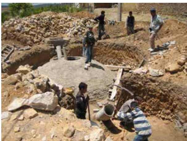
Image 422 : Vue de la cuve centrale avec les buses d'alimentation et de sortie.
