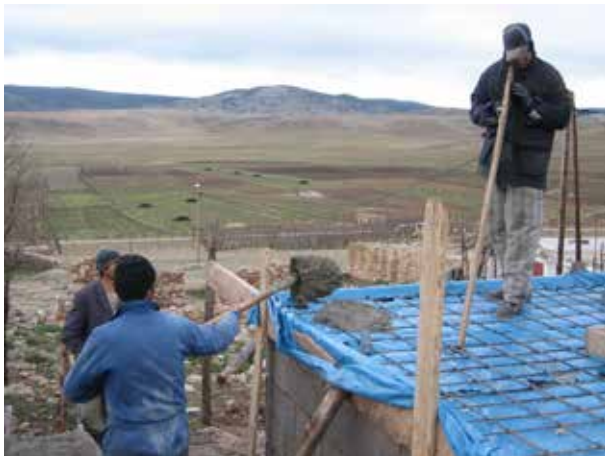
Image 40 : Le béton est distribué sur le support et lissé à l'aide d'une planche.
