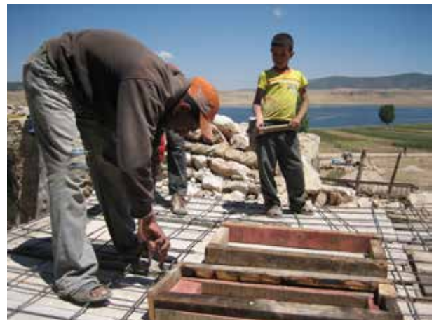
Image 306 : Préparation du ferrailage autour des deux cadres en bois qui servent comme formes pour les sièges de toilette.
