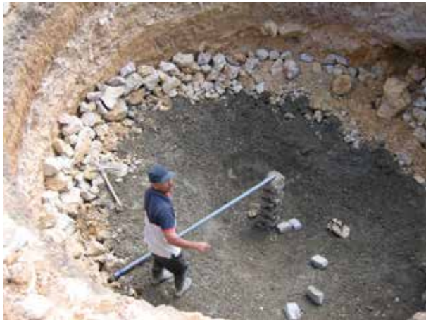
Image 390 : Un mur provisoire de 2 briques d'épaisseur fixe le clou qui définit le centre du dôme. La baguette de mesure est à l'horizontale. Elle est utilisée pour construire le mur sphérique du dôme.
