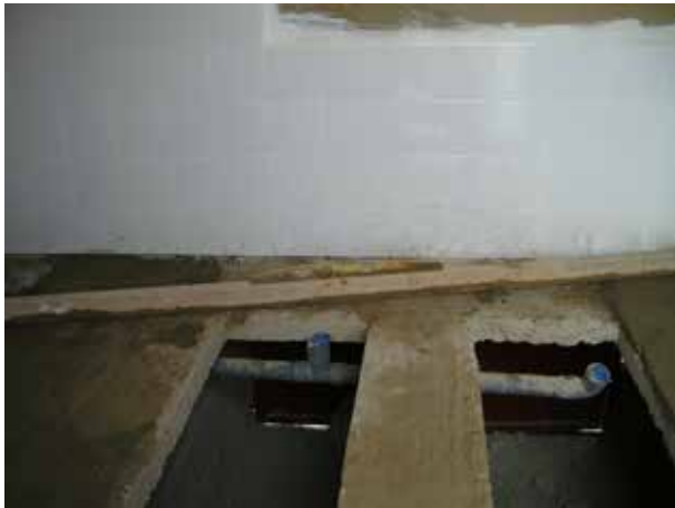
Image 340 : Les deux refoulements pour les sièges de toilette. Les tubes visibles serviront à l'évacuation des eaux de nettoyage anal vers le puisard.
