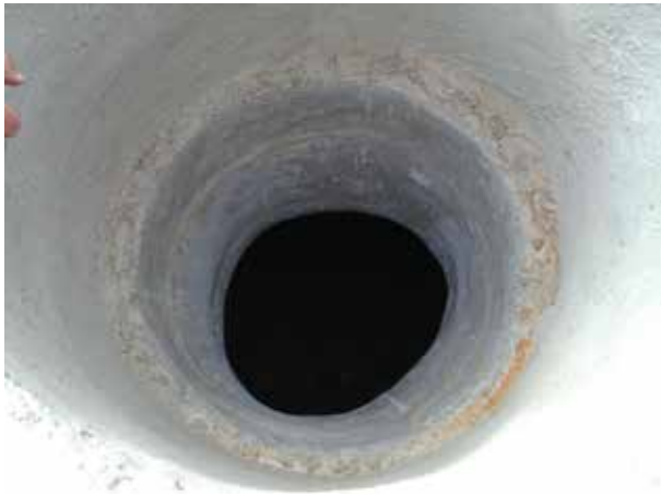
Image 471 : Finition de la surface intérieure de la couronne de couvercle (mortier étanche et lait de ciment).
