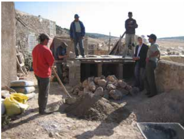
Image 317 : Le support de la dalle reste lorsqu'on commence avec la maçonnerie de la superstructure.
