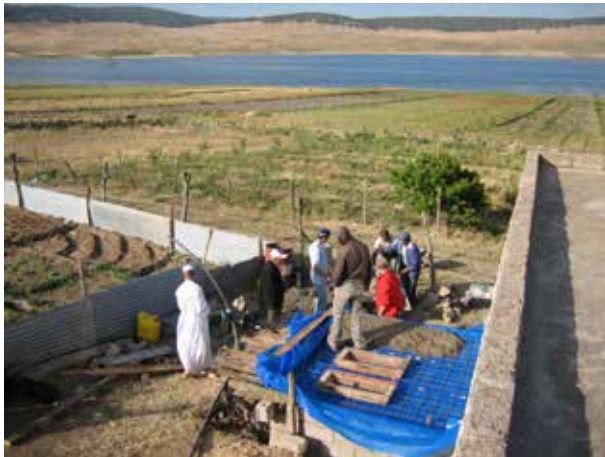
Image 147 : Vue du chantier et du lac pendant la coulée de la dalle.
