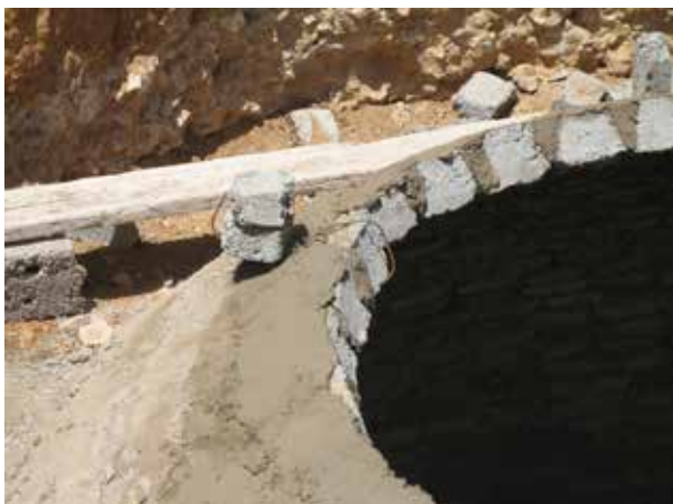
Image 416 : Pour les dernières rangées, l'emploi de contrepoids est nécessaire pour retenir la première brique d'une rangée et l'avant-dernière qui vient d'être placée.
