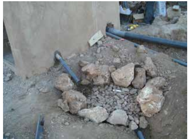
Image 285 : Vue extérieure de la tuyauterie et du puisard pour l'infiltration des eaux de nettoyage anal.
