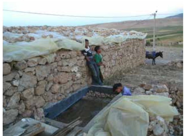
Image 294 : Vue du filtre avec tuyau d'entrée pendant la mise en place du matériau de filtration.
