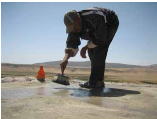
Image 66 : Arrosage du toit pour prévenir des fissures. Une bouteille couvre la sortie de la cheminée.
