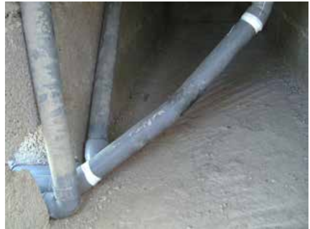
Image 182 : Sortie des trois conduites pour eaux grises lavabo/douche, urine et eaux de nettoyage anal (placement provisoire).
