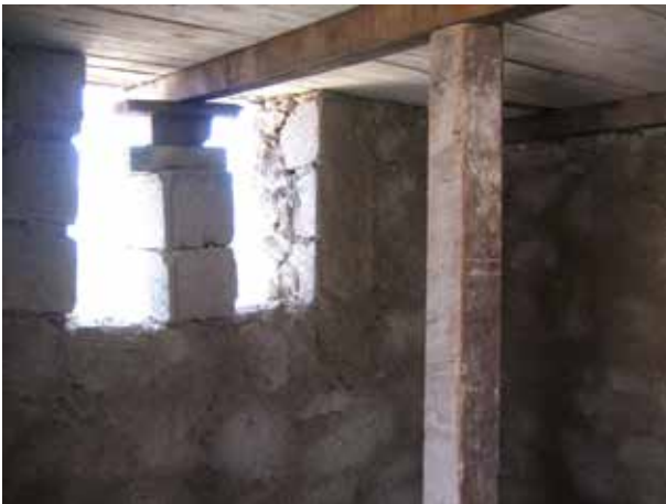
Image 327 : Support pour le toit.
