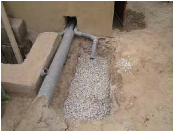
Image 187 : Le gravier concassé est le matériau de filtration principal dans le puisard pour les eaux de nettoyage anal.
