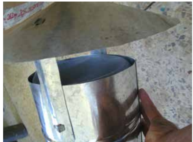
Image 712 : Moustiquaire placé sous le chapeau au bout du tuyau de ventilation.
