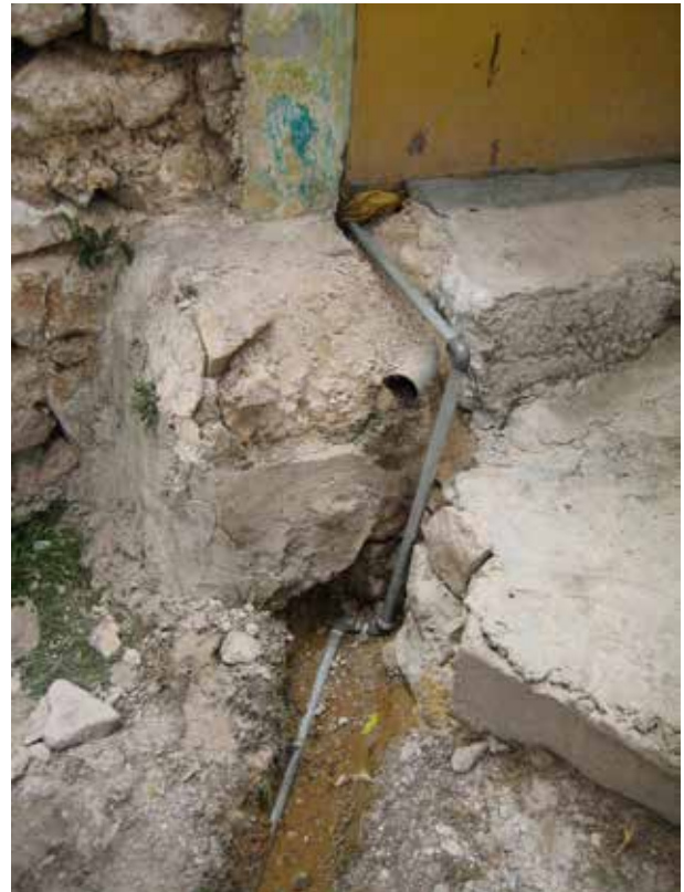
Image 441 : La conduite entre dans la maison.
