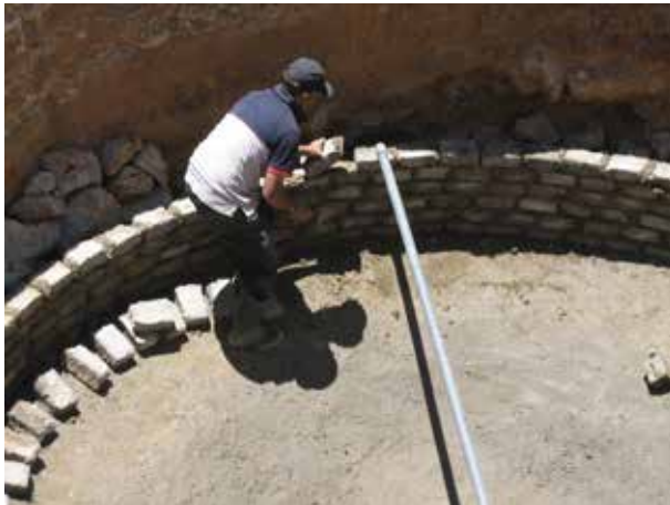
Image 402 : Pose d'un bloc sur le mortier. Les joints sont décalés par rapport à la rangée précédente.
