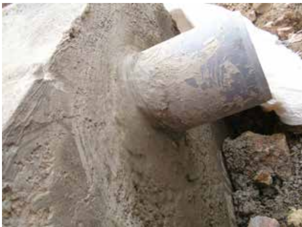
Image 370 : Le tuyau de sortie est intégré dans le mur du bassin.
