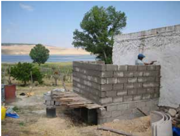
Image 154 : Construction des murs de la superstructure. Le maçon est en train de faire un trou dans le mur de la maison pour ancrer la TDSU par des pièces de fer rond.
