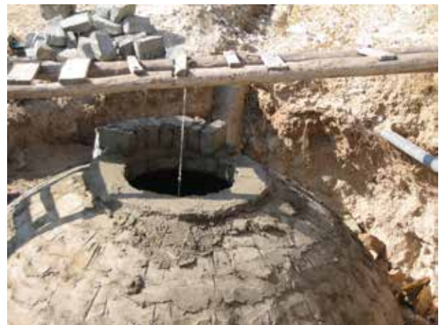
Image 520 : Construction de la couronne de couvercle du digesteur à l'aide d'un fil à plomb centré.
