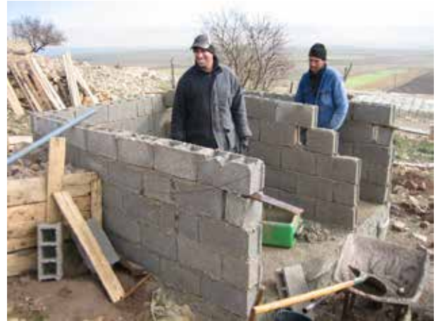
Image 31 : Une niche est prévue pour le linteau de baie et le tuyau de ventilation, ainsi qu'un trou pour les tuyaux.
