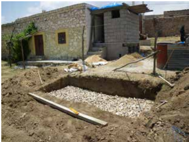
Image 202 : Une couche horizontale de moellons forme la base pour la dalle (dalle) du filtre planté.
