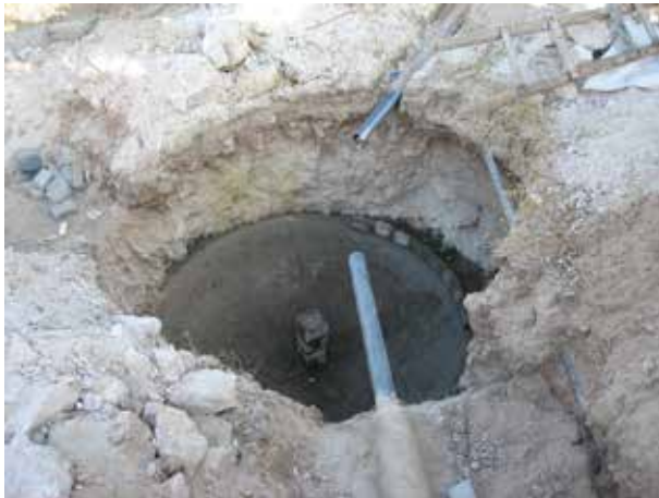
Image 503 : Un mur provisoire de 2 briques d'épaisseur fixe le clou qui définit le centre du dôme. Les premiers blocs sont posés autour de la cuve.
