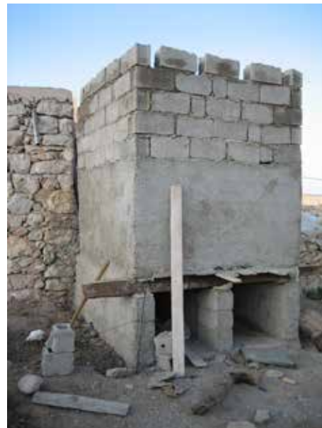
Image 265 : Les niches dans la dernière rangée de briques serviront à la construction du support pour le toit.
