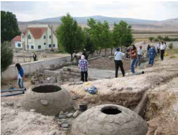
Image 550 : Pose de la dalle de fond. Simultanément la première rangée de briques est posée par les participants de l'atelier de construction.
