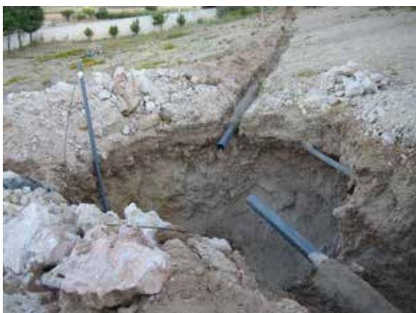
Image 499 : Arrivée des tuyaux d'eaux usées de la mosquée et de l'école.
