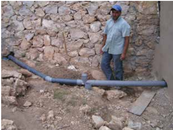
Image 282 : La conduite des eaux grises de la maison passe par le bâtiment de la toilette vers le filtre planté.
