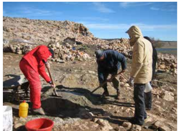
Image 19 : Le béton est gâché à la main à cause d'absence d'une bétonneuse.
