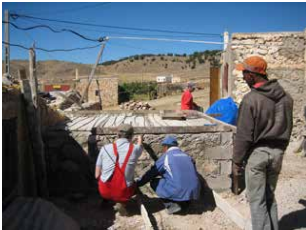
Image 303 : Installation d'un support et coffrage pour la dalle, discussion du placement de l'escalier.
