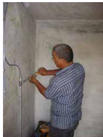
Image 476 : Installation d'un manomètre à eau dans la cuisine.
