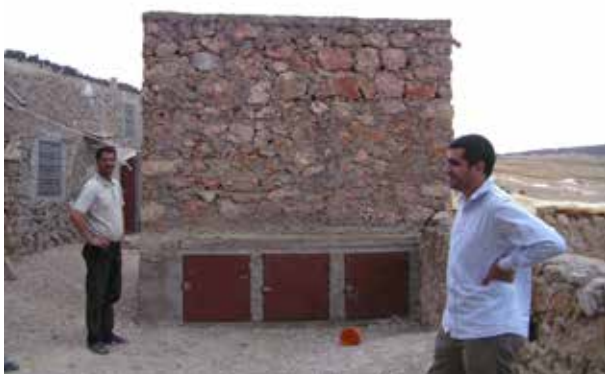
Image 335 : La superstructure finalisée après installation des trois portes des fosses et du linteau au-dessus. Les ouvriers ont oubliés d'installer le coude pour le tuyau de ventilation.
