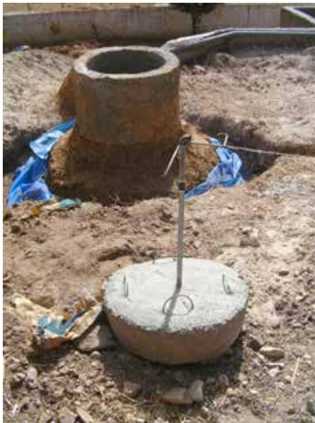
Image 531 : Couvercle du digesteur avec quatre poignées et tuyau galvanisé.
