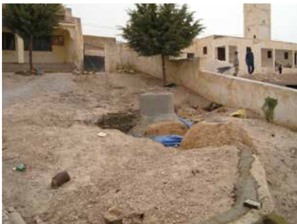
Image 533 : Un regard du piège à eau est construit à côté du digesteur, ainsi que la protection de la conduite des eaux pré-digérées vers le filtre.
