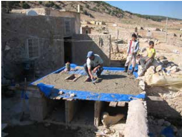
Image 309 : Vue de la TDSU et de la maison de la famille bénéficiaire pendant la coulée de la dalle.
