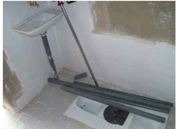
Image 279 : Le lavabo est branché à la conduite d'eaux grises.
