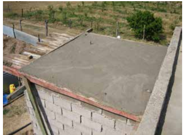
Image 163 : Le toit juste après la coulée du béton. On voit les garde-places pour la sortie de la cheminée et une éventuelle conduite d'eau.
