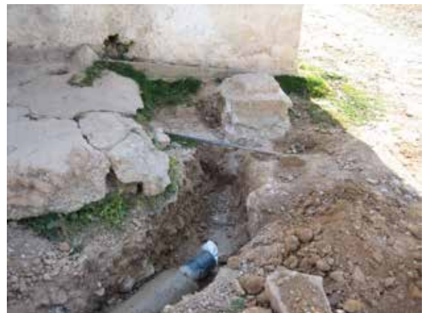
Image 486 : Le puits perdu de la mosquée, où la conduite sera raccordée. Le trou et la rigole visible au mur est la sortie des eaux grises.
