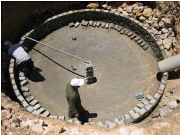
Image 394 : Construction des premières rangées de briques. La buse du bassin d'expansion est déjà posée.
