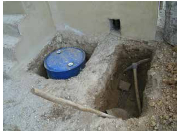
Image 184 : Le réservoir d'urine est placé et l'excavation de 80 cm est faite pour le filtre pour l'eau de nettoyage anal (puisard).
