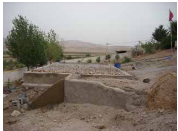
Image 583 : Vue latérale du filtre végétalisé.
