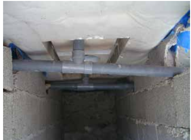
Image 347 : Vue de la tuyauterie dans la fosse au milieu.
