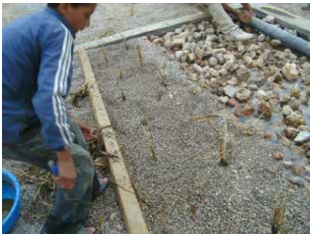
Image 578 : Plantation du filtre. Des côtés entrée et sortie des gros graviers (moellons) ont été posés.
