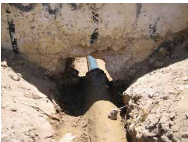
Image 493 : La conduite passe par le mur de la cour de l'école.
