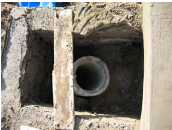
Image 437 : Compartiment avec la buse d'alimentation et la conduite des eaux usées.
