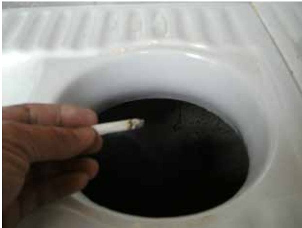
Image 199 : Test de fonctionnement de la ventilation – la fumée descend dans la fosse et remonte par le tuyau de ventilation, ce qui prouve que le courant d'air fonctionne.
