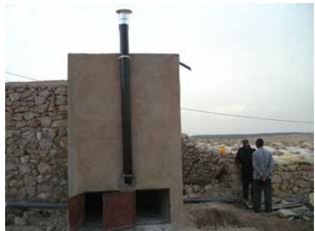
Image 281 : Tuyau de ventilation, tuyau pour l'évacuation des eaux de pluie et portes des fosses sont installés.
