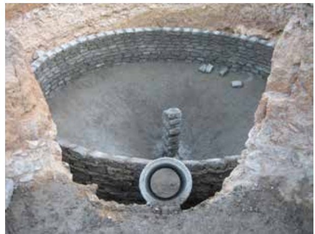
Image 405 : Vue de la buse du bassin d'expansion et de la cuve du digesteur.
