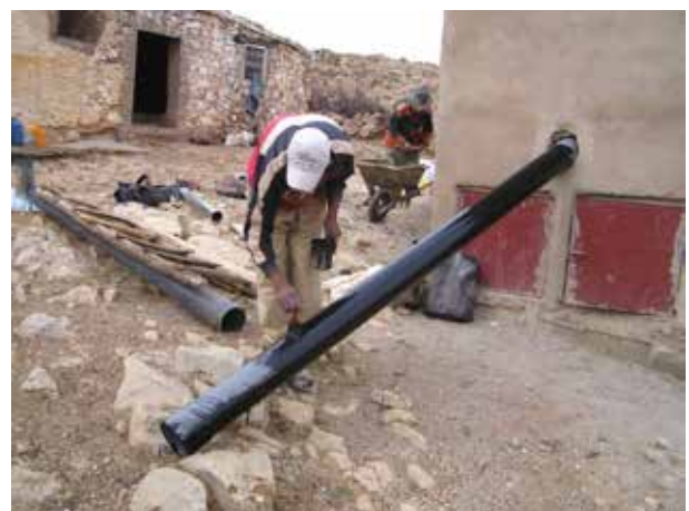
Image 89 : La peinture noire sur le tuyau de ventilation cause un chauffage solaire augmenté, ce qui supporte le courant d'air.
