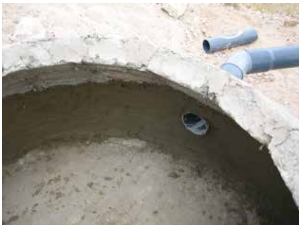
Image 519 : Sortie des eaux prétraitées du bassin d'expansion.
