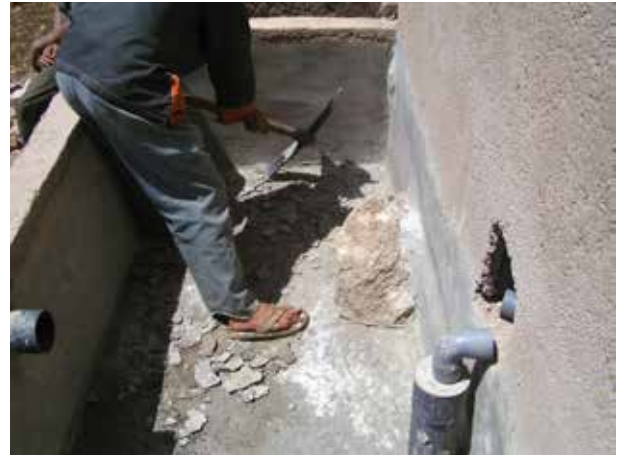
Image 120 : Il fallait remplacer la mauvaise couche d'enduits pour assurer l'étanchéité du bassin.
