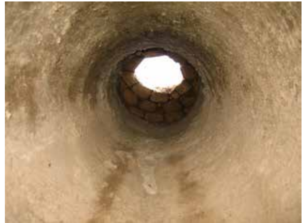
Image 428 : Buse de sortie vue de l'intérieur du digesteur.
