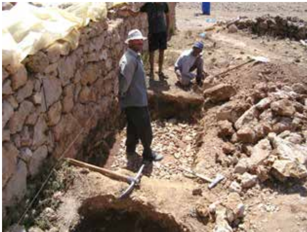
Image 287 : Une couche horizontale de moellons est placée dans l'excavation finalisée. En bas on voit l'excavation ronde pour le réservoir d'urine.
