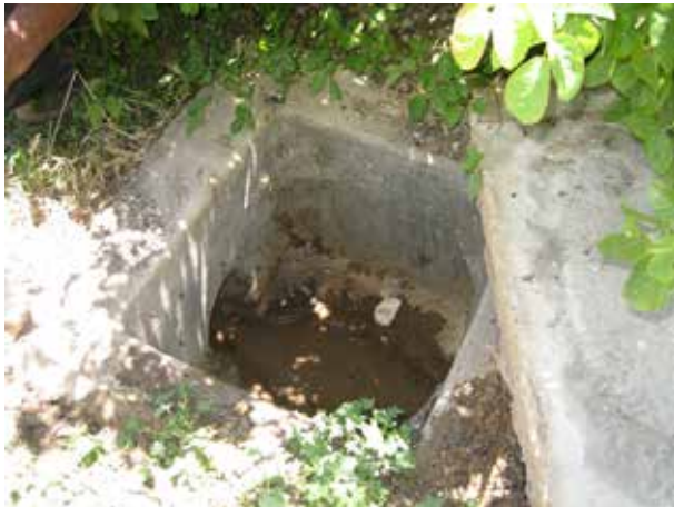
Image 495 : Chambre de visite existante près de la borne-fontaine de l'école.
