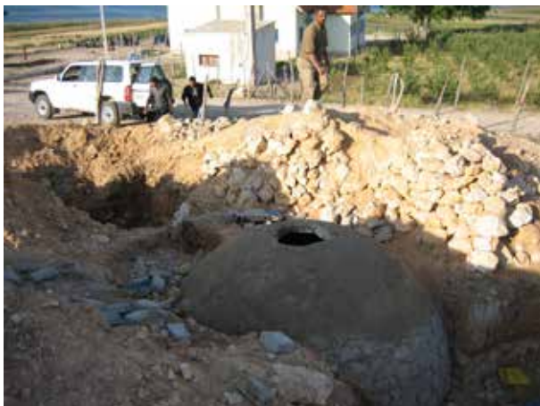
Image 446 : Les rangées de briques sont montées jusqu' à obtenir un trou au sommet de 60 cm de diamètre. Une couche de béton est posée à l'extérieur.
