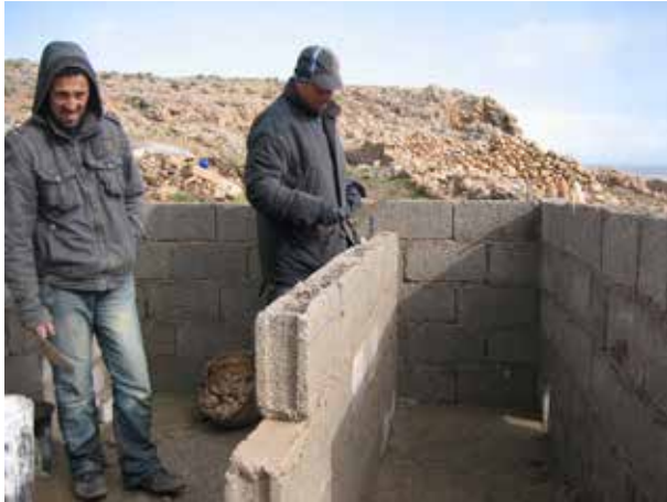
Image 30 : Construction des murs de séparation. En bas on voit le trou de sortie prévu pour la tuyauterie.
