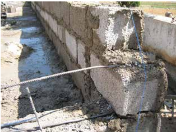
Image 558 : Renforcement des angles par des fers à béton de 8 mm à chaque niveau de briques.
