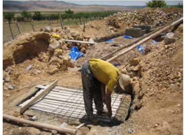
Image 465 : Préparation du coffrage et ferrailage pour le couvercle de la fosse de stockage.
