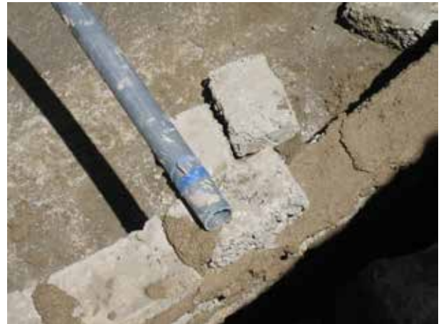
Image 397 : Positionnement radial des blocs à l'aide de la baguette de mesure. Il faut bien remplir les joints de mortier.
