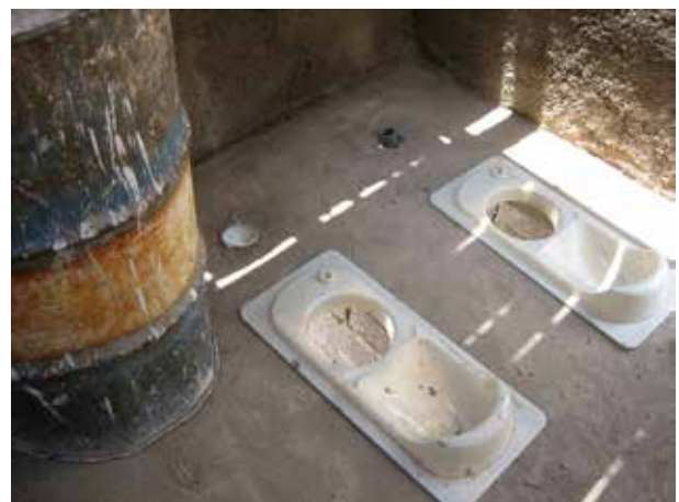
Image 49 : Sièges de toilette (type chinois en plastique) provisoirement positionnés dans la dalle.
