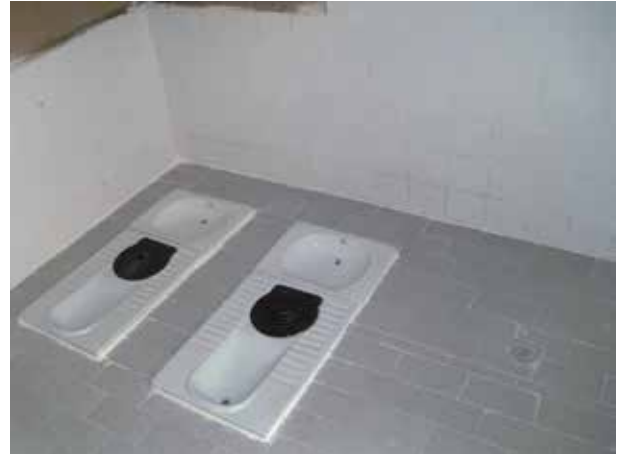
Image 198 : Les deux sièges à séparation d'urine et le siphon de sol de la douche.
