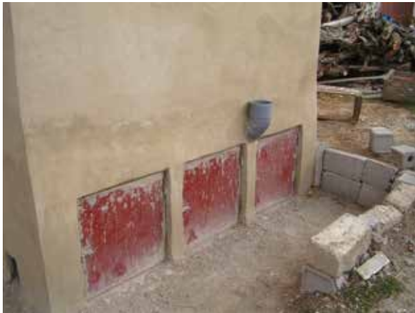
Image 172 : Le linteau au-dessus des portes est finalisé, le coude de 45° pour le tuyau de ventilation est placé et les enduits sont appliqués.
