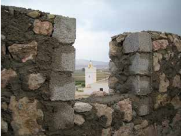
Image 325 : Des briques sont utilisées à la face interne du mur pour former la niche de la fenêtre.
