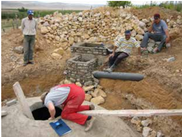
Image 435 : L'arrivée des eaux usées est connectée à la buse d'alimentation.
