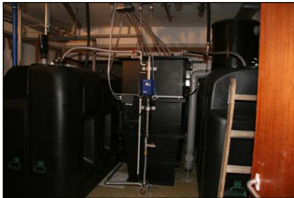
Grauwasseraufbereitungsanlage (Fa. Hans Huber AG)
