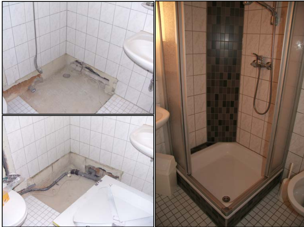
Systemtrennung in einem Duschbad während (links) und nach Beendigung des Umbaus (rechts)
