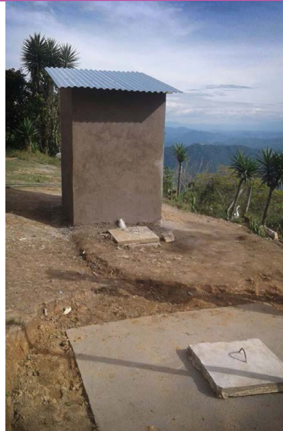
Pour flush toilet with a distribution box and one pit.
