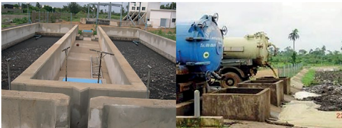
Figura 6.2 Los dos tanques de sedimentación y espesamiento de la Estación de Tratamiento de Lodos Fecales Rufisque en Dakar, Senegal (izq.). El ciclo operativo dura 2 semanas (1 semana de uso, otra de reposo) y luego se bombean los lodos a lechos de secado. La laguna de sedimentación y espesamiento en Achimota, Accra, Ghana, tiene un ciclo operativo de 8 semanas (4 semanas de uso, 4 semanas de reposo; der.). Como los lodos se espesan durante 4 veces más tiempo, no es posible extraerlos con una bomba y su retiro es manual (foto: SANDEC).
