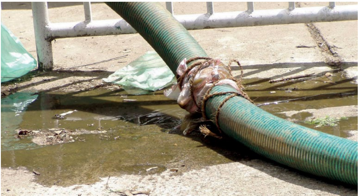
Figura 4.4 Las mangueras y sus accesorios requieren frecuente atención y reparación para mantenerles funcionando debidamente. Esta foto muestra un caso de mantenimiento inadecuado, con fugas de LF que salen de roturas en una manguera (foto: David M. Robbins).
