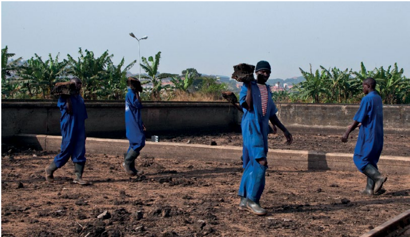
Figura 11.7 Sacando el lodo de los lechos de secado en la Estación de Tratamiento Bugolobi en Kampala, Uganda (foto: Linda Strande).
