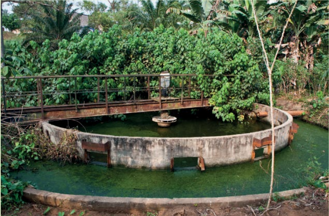
Figura 17.3 Una estación depuradora de aguas residuales que ya no funciona en Yaoundé, Camerún (foto: Linda Strande).
