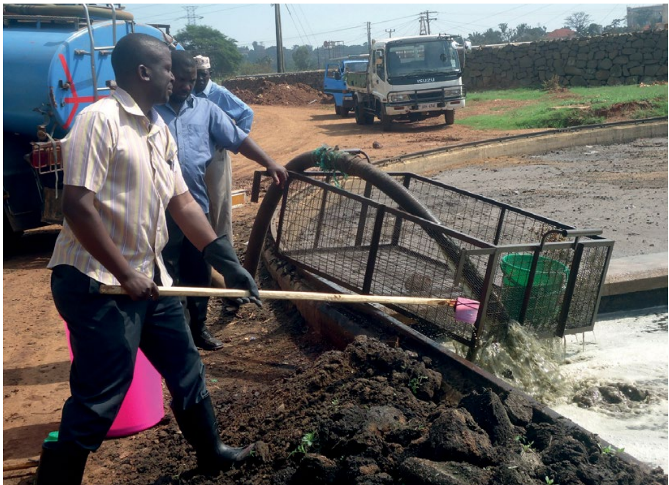
Figura 2.5 Separación de desechos sólidos de los lodos fecales mediante un tamiz de barras, en el afluente a una estación de tratamiento, durante un evento de muestreo en Kampala, Uganda (foto: Daniel Ddiba).
