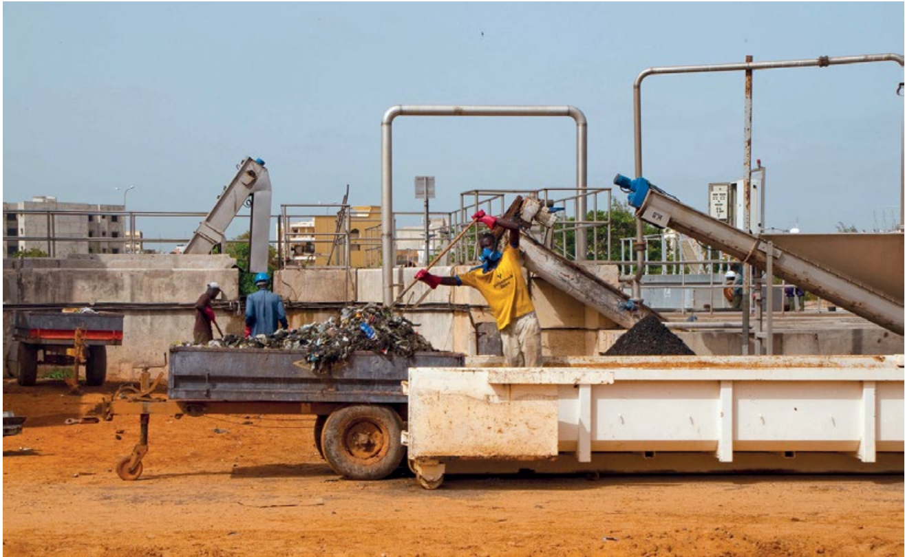
Figura 11.1 Limpieza de los tamices en una estación de tratamiento de lodos fecales en Dakar, Senegal; esta actividad es imprescindible en cada turno para mantener el sistema operativo (foto: Linda Strande).
