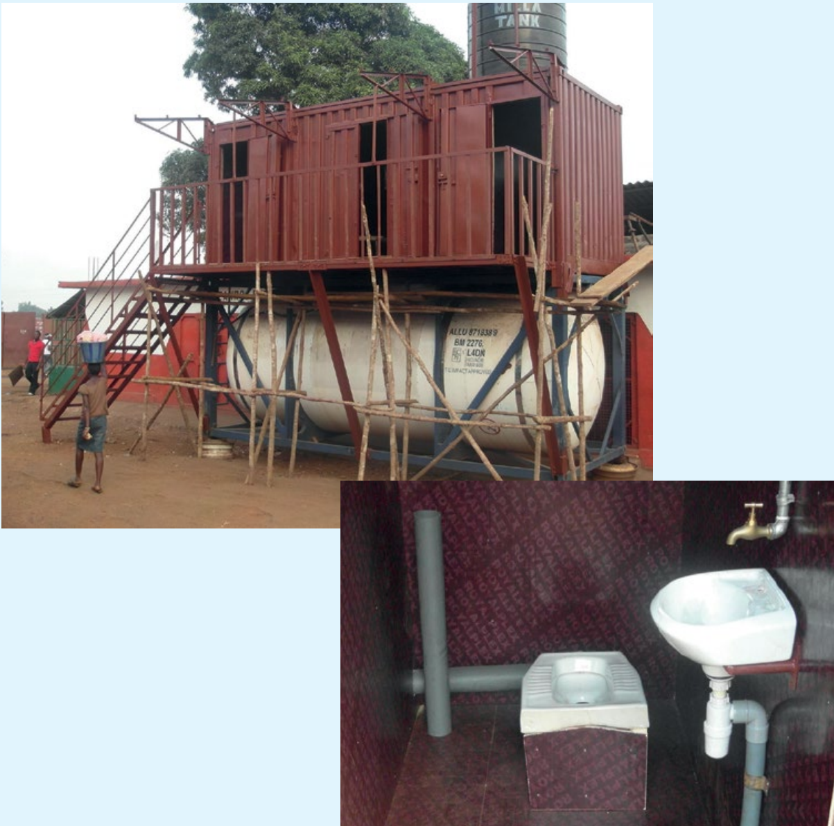
Figura 4.17 Estación de transferencia multifuncional, modular y de gran volumen (arriba) y uno de sus inodoros (abajo) (foto: GOAL).
