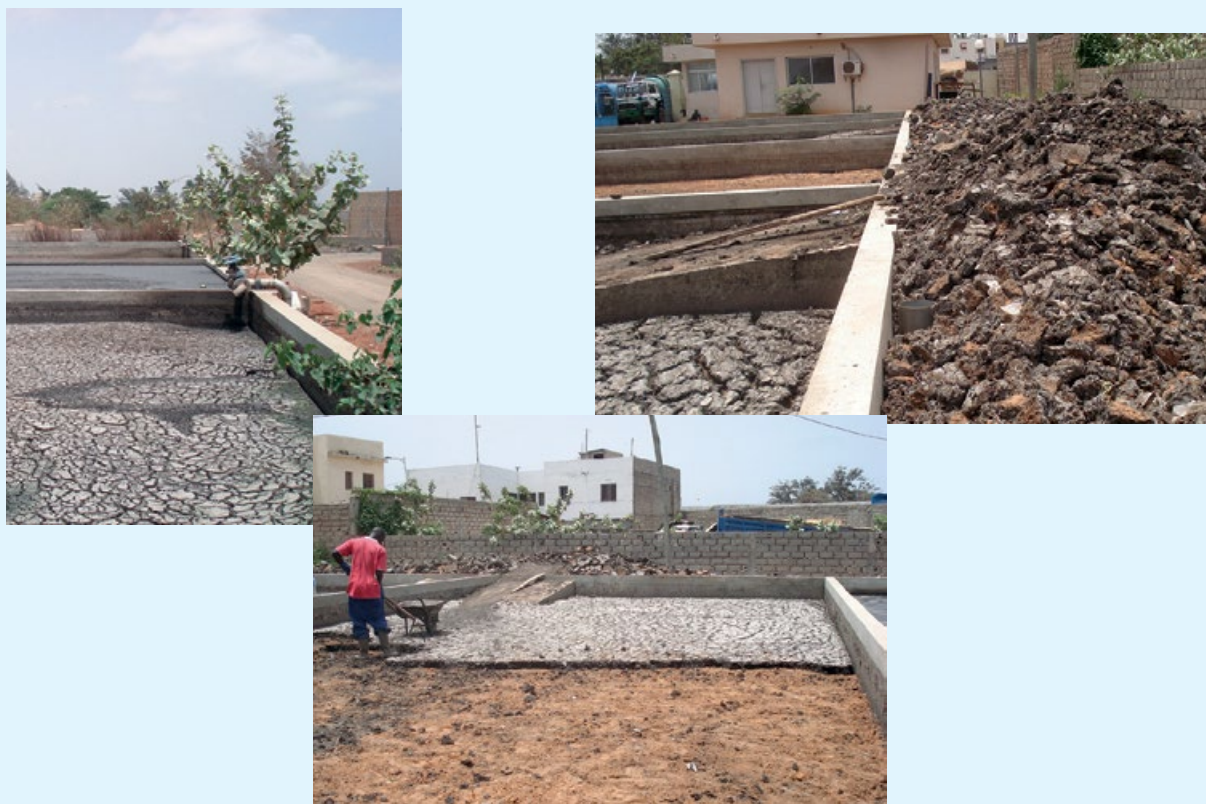
Figura 7.6 Lechos de secado sin plantas, con la acumulación y extracción de los lodos (der.), en la Estación de Tratamiento de Lodos Fecales Cambérène, en Dakar, Senegal (fotos: Pierre-Henri Dodane).
