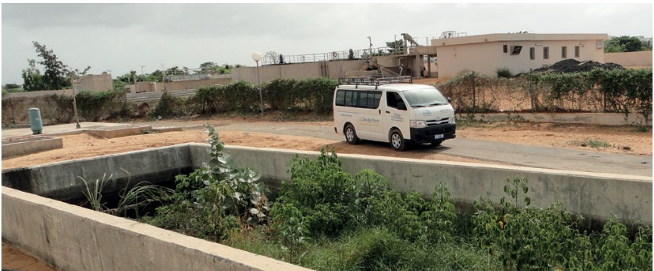
Figura 6.5 Ejemplo de operación y mantenimiento inadecuados de un tanque de sedimentación y espesamiento en África Occidental. La nata no se había sacado durante tanto tiempo que ciertas plantas ya crecían sobre ella. La acumulación de un exceso de lodos o nata impide la debida operación de este tipo de tanque que sirve para decantar sólidos y líquidos (foto: SANDEC).
