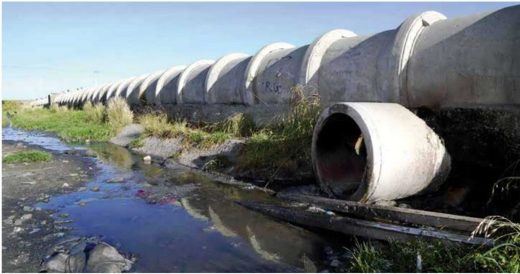
Línea principal de alcantarillado de la planta de tratamiento de aguas residuales de Puchukollo perforada por la población local para desviar el agua para el riego y la ganadería. Foto: Gabriel Barceló, Banco Mundial.
