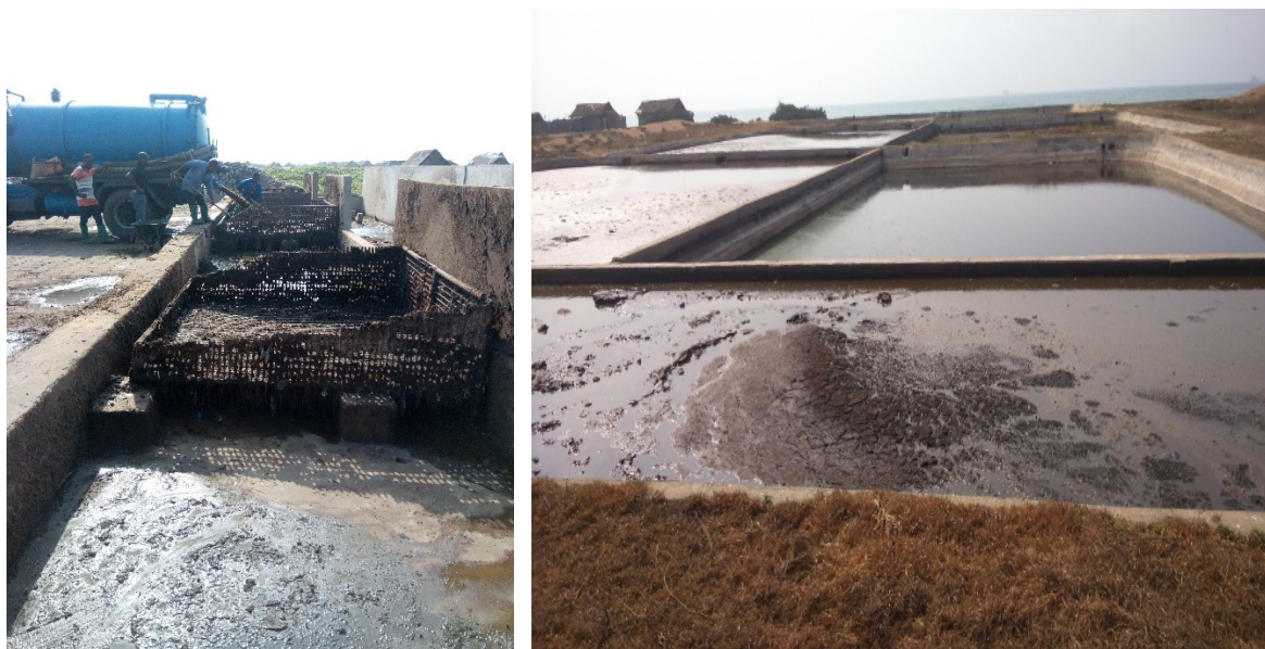
Figure 6: Station de traitement des eaux usées de SIBEAU, surexploitée (2018).
