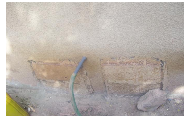
Figure 14 : Latrine mal utilisé (présence d'eau sur les murs : mairie de Boulmiougo)
