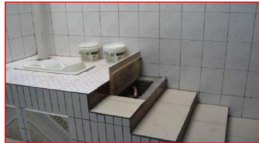
Figure 25 : Trappe d'accès au bidon d'urine d'une UDDT en Chine
