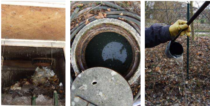
Abb. 10: Kompostmaterial im Inneren des Kompostbehälters (links), Grauwasser im Imhoff-Tank (Mitte) und Ablauf aus der Pflanzenkläranlage (rechts). Quelle: A. Schöpe, 2009.
