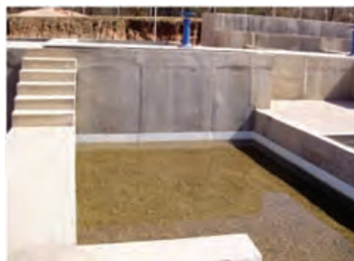
Filtro Grueso Ascendente Loc. Villamontes
