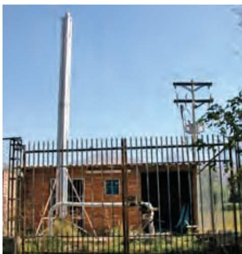
Foto 3. Torre Hidroneumática Clásica
