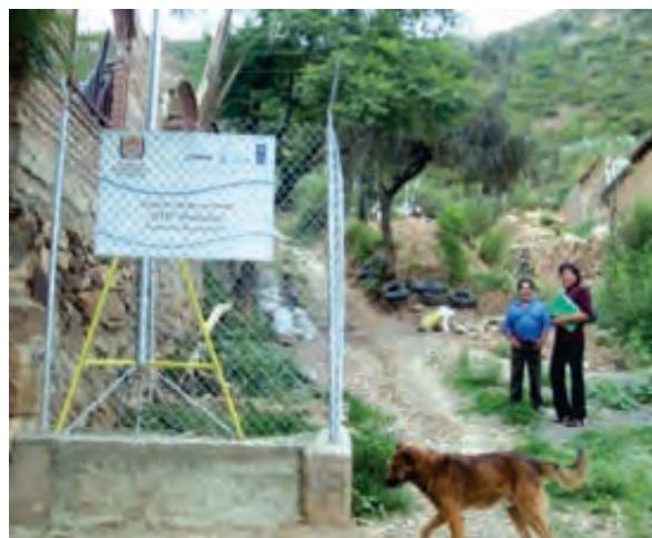
Foto 4. Torre Hidroneumática Mini zona de Incacollo – Muyurina Cochabamba
