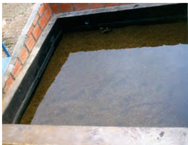
Foto 1. 2 Filtro de grava de flujo ascendente
