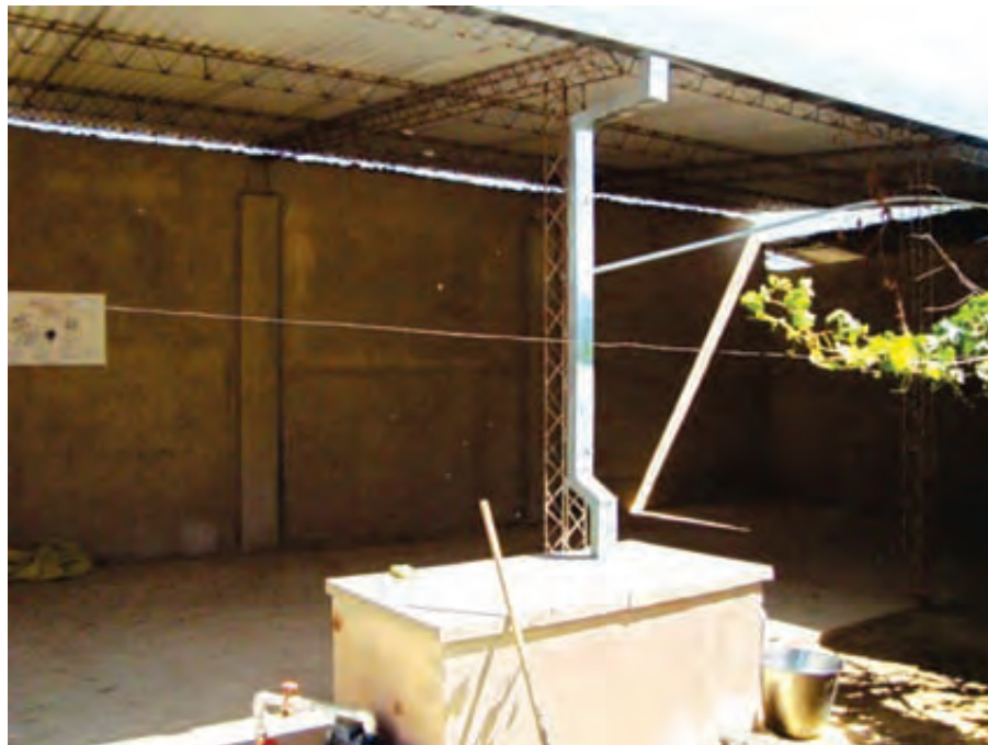
Foto 1.1 Bajante e interceptor Localidad: Ciudad de Cochabamba
