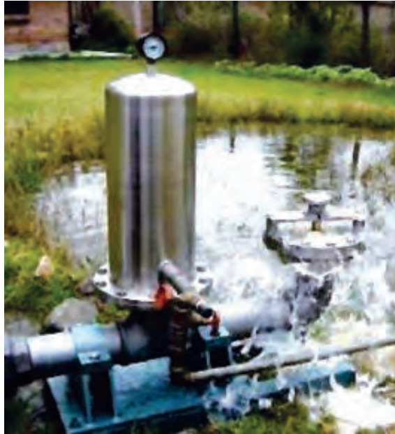
Foto 1.1 Bomba de Ariete en funcionamiento
