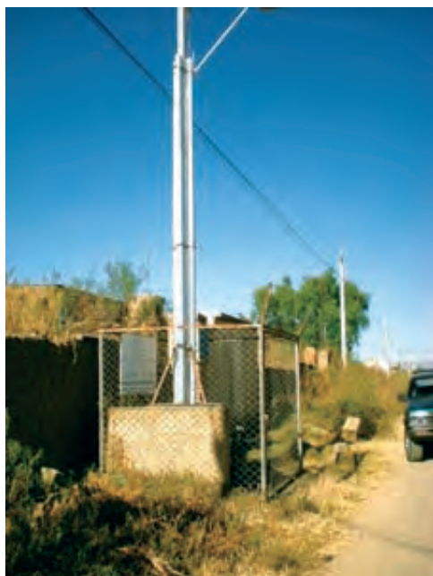
Foto 1. Torre Hidroneumática 4 cilindros zona de Molle Molle – C. Cochabamba
