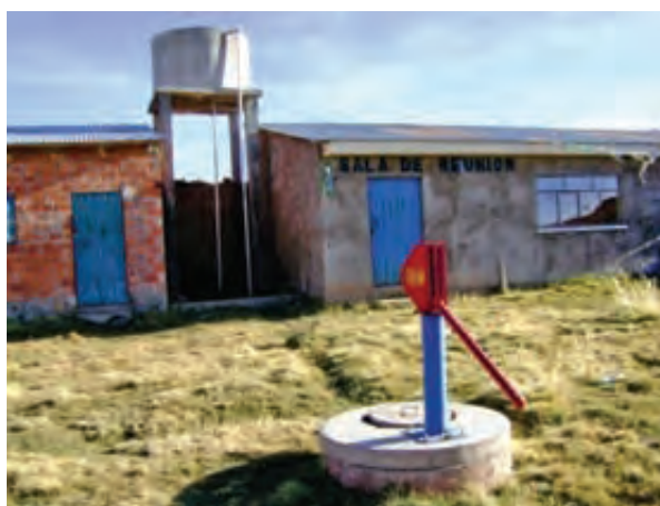
Foto 2.2. Bomba Wara de elevación Comunidad: Tambillo-módulo lechero
