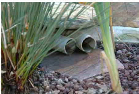
Entrée du deuxième niveau de traitement planté de scirpes
