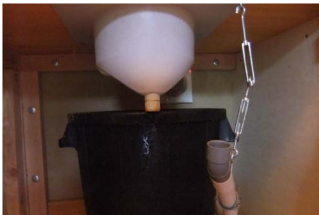
Vue du dessous de la lunette séparative avec raccordement aux urines et réceptacle des résidus de toilettes sèches. Le caisson est étanche et ventilé.
