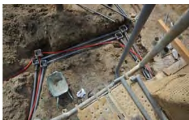
Canalisation eaux grises, urines et gaine électrique
