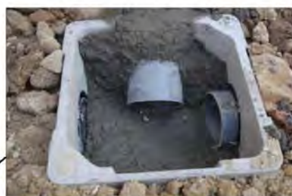
Regard de collecte des eaux grises
