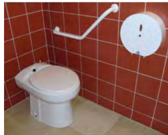
Toilettes sèches unitaires de chez Wostman écodry accessibles aux personnes à mobilité réduite (PMR) installées dans une salle des fêtes
