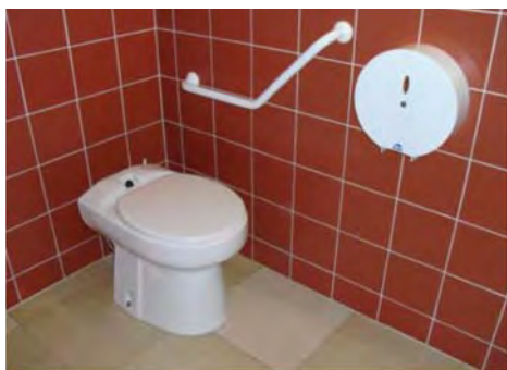
Toilettes sèches séparatives installées à l'intérieur de la salle des fêtes et accessibles aux personnes à mobilité réduite
