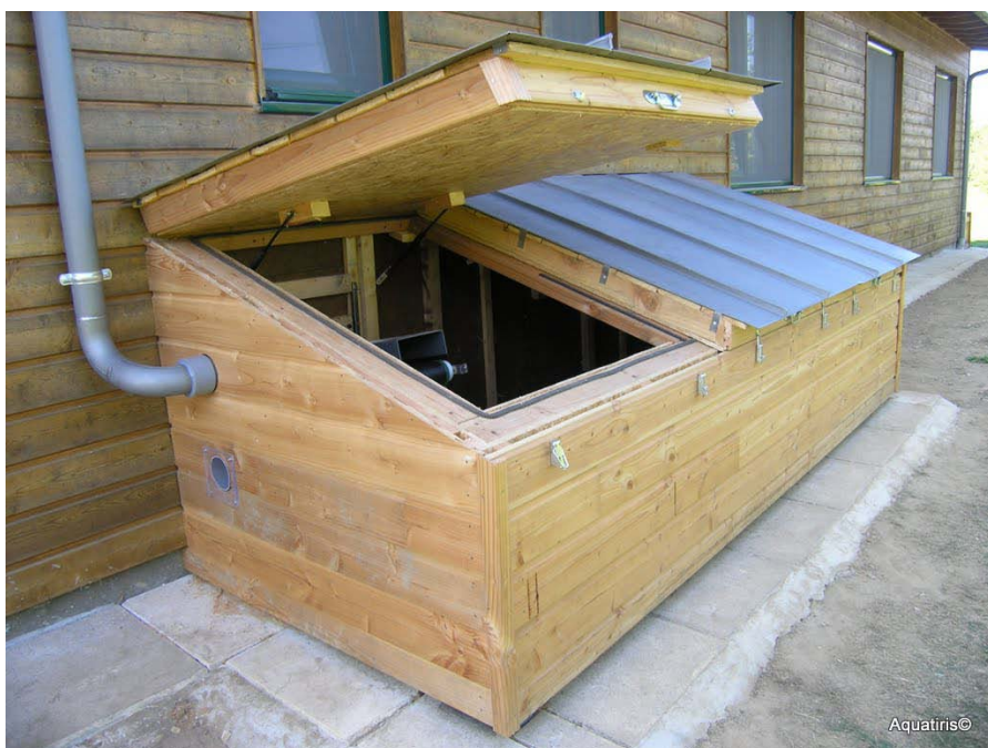
Modèle de composteur isolé et sa ventilation installée en Bretagne
