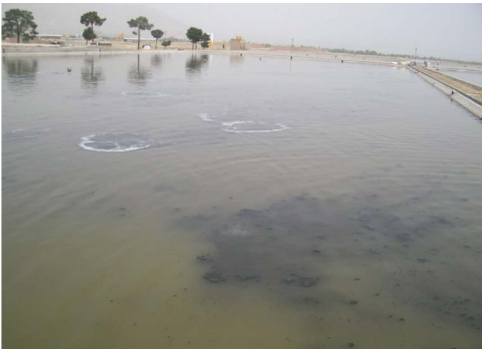
Bild 14: Kläranlage Tehran South: Unbelüftete Teiche mit Schlammfladen und Gasausbrüchen
