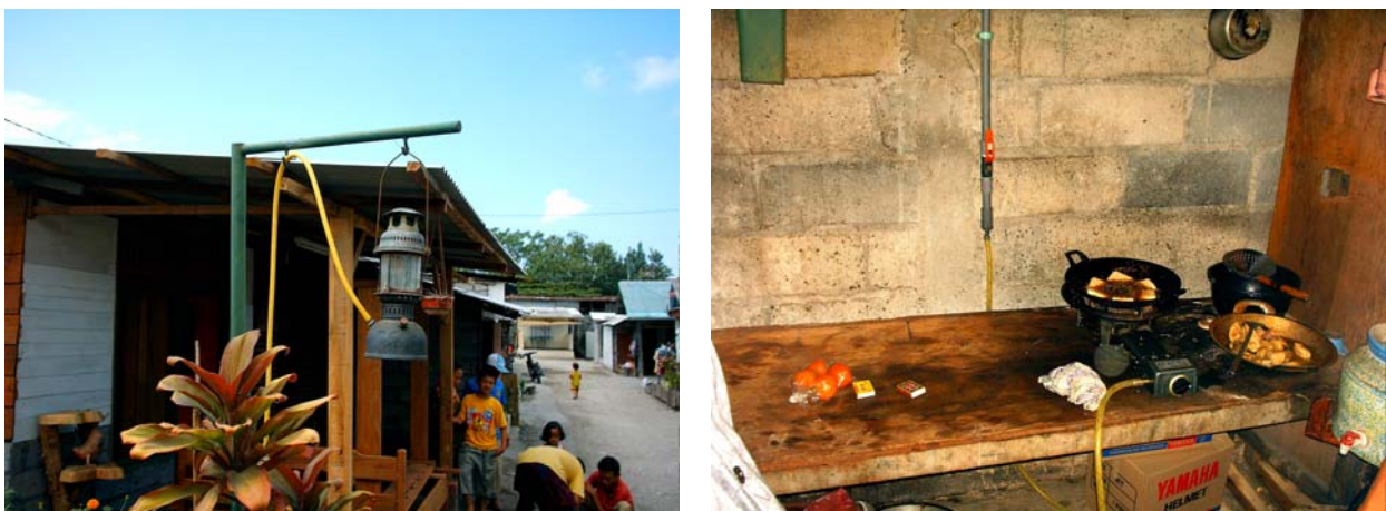
Bild 26: Mit Biogas betriebene Außenbeleuchtung und Gaskocher
