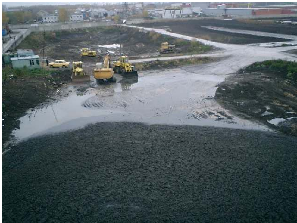
Bild 10: Blick von einem der hoch stehenden Gebäude über die freien Lagerflächen für den ausgefaulten und entwässerten Schlamm, der von dort aus auf Schlammflächen (Deponien) verbracht wird
