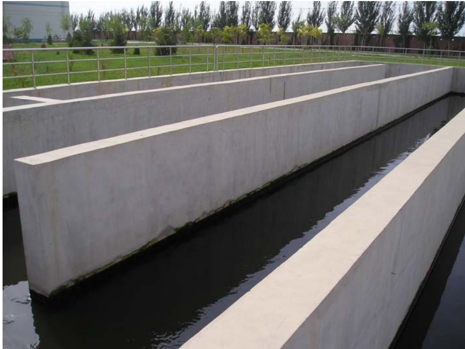
Bild 14: Chlorbecken Abwasserbehandlungsanlage Yinchuan
