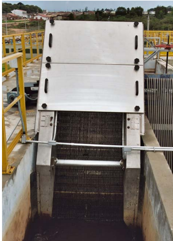
Bild 5: Rechenanlage der Kläranlage in Curitiba
