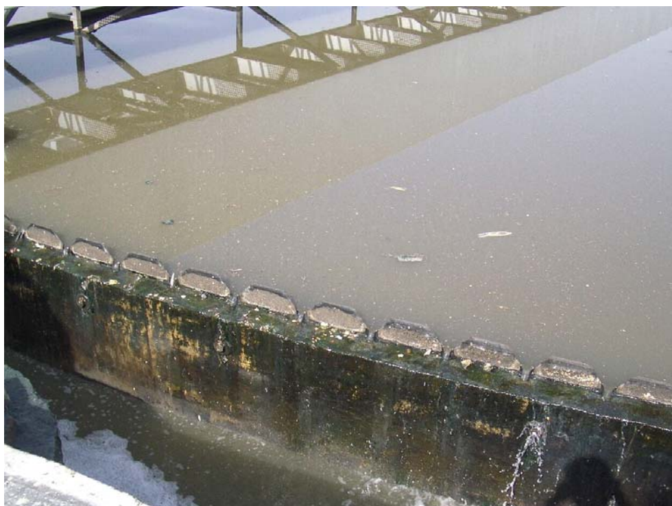
Bild 29: Esfahan, Kläranlage Nord: Kläranlagenablauf (Trübung)
