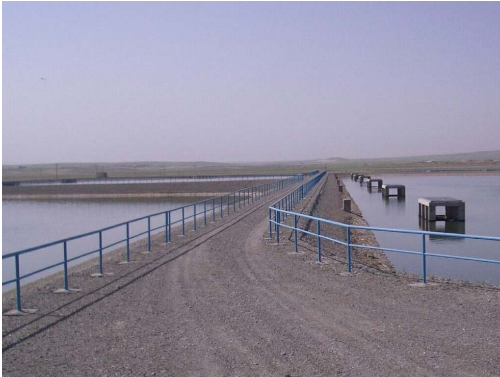
Bild 22: Kläranlage Mashhad East: Überlaufwehre aus dem fakultativen Becken (rechts) in den Schönungsteich (links)
