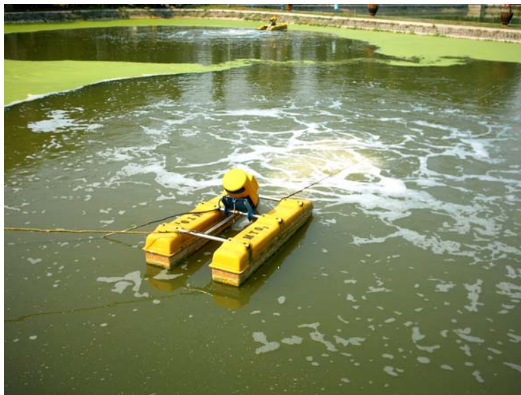
Bild 12: Oberflächenbelüftung, Fa. MTO2, Abwasserteich der KA Semanggi
