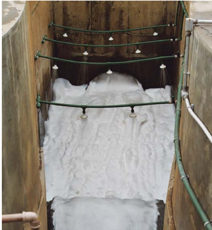
Bild 9: Problem der Schaumbildung: Kläranlage in Curitiba, Kanal mit Wasserdüsen
