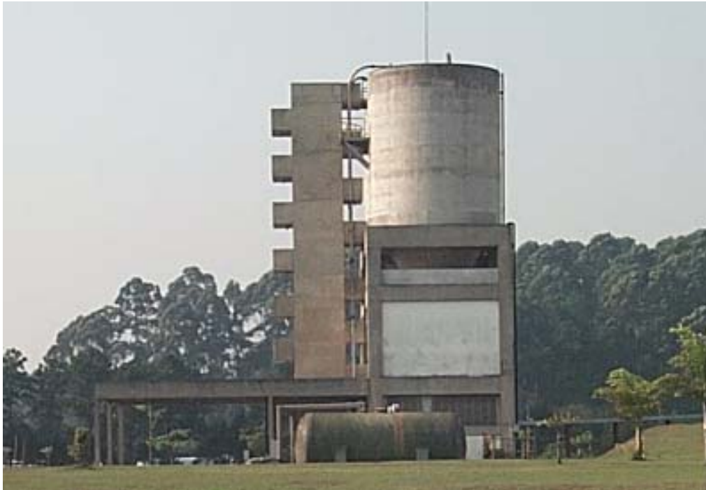
Bild 14: Ein Faulbehälter der Kläranlage ETE ABC, São Paulo
