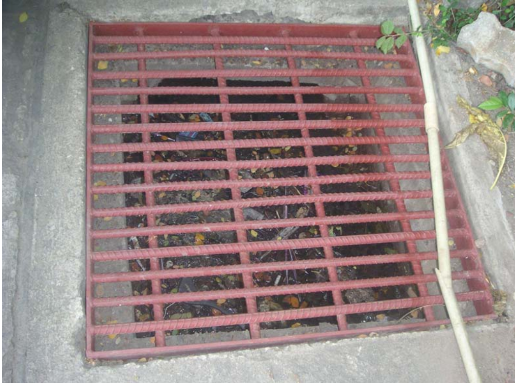
Bild 4: Beispiel eines einfachen Straßeneinlaufs
