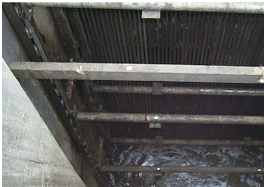
Bild 6: Mittelrechen der Kläranlage ETE ABC, São Paulo
