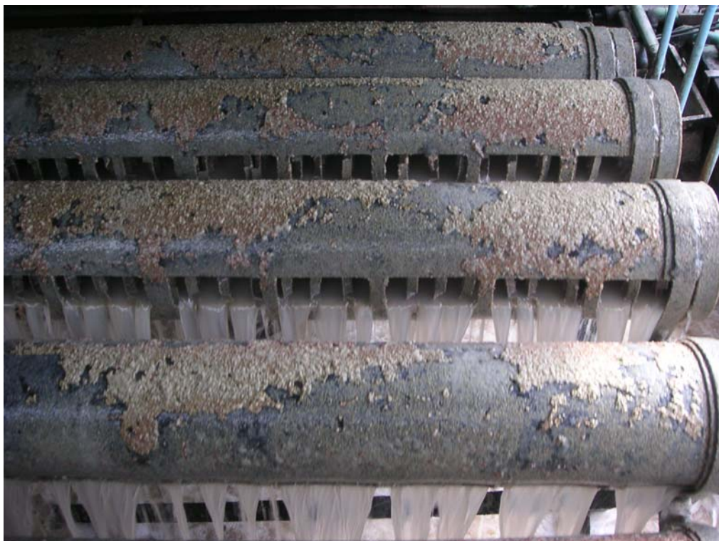
Bild 7: Stählermatikanlage in einer Molkerei
