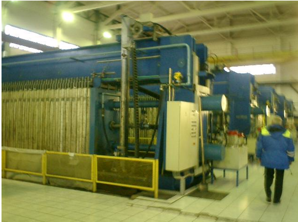
Bild 9: Schlammfilterpressen (Fabrikat Netzsch, Polypropylenplatten)
