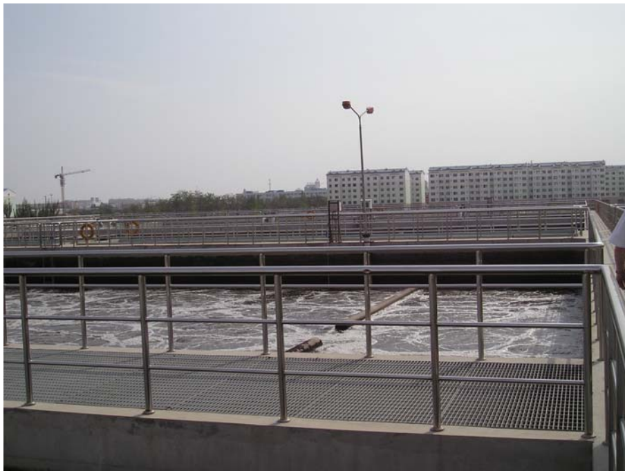
Bild 6: Abwasserbehandlungsanlage Yinchuan (SBR-Verfahren)
