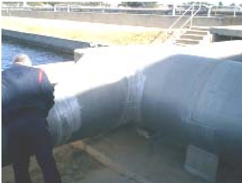
Bild 15: Druckluftzuleitung für die feinblasige Belüftung einer großen Belebungsanlage mit nachgebesserten Schweißnähten und Reparaturstellen
