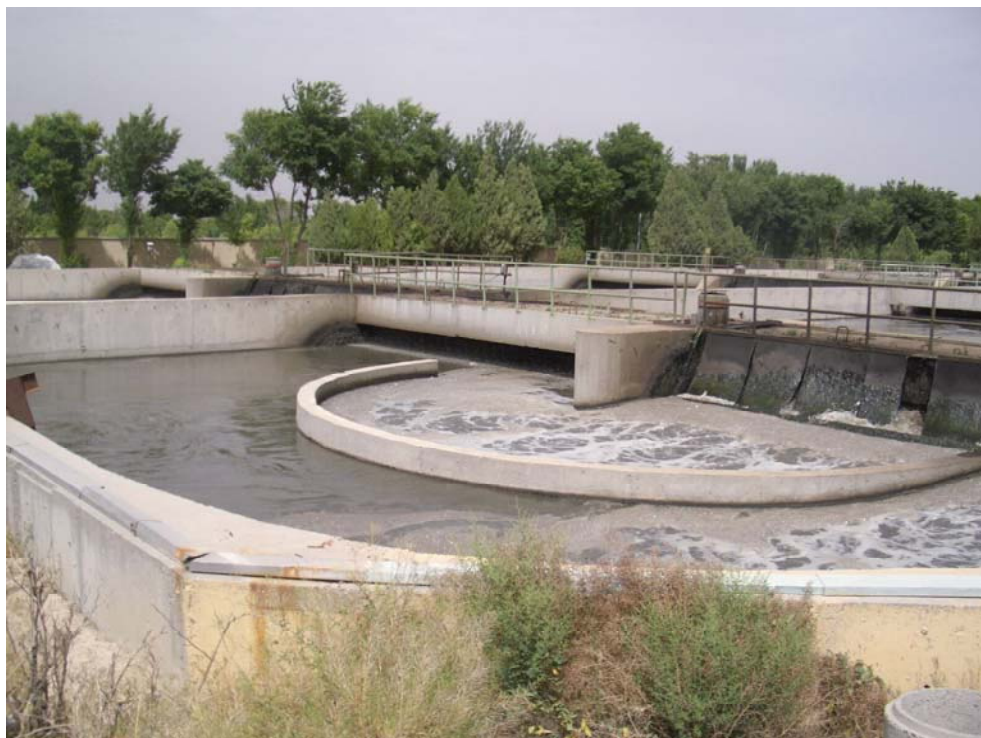
Bild 25: Esfahan, Kläranlage Süd: Umlaufgraben mit Walzenbelüfter
