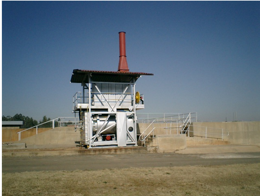
Bild 18: Rechengut-Verbrennungsanlage in dezentraler Positionierung auf einer Großklär-anlage
