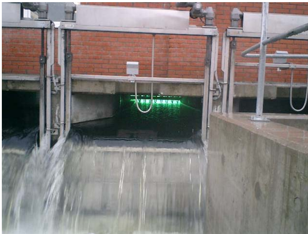
Bild 14: Abwasserablaufklärwerk Zelenograd: Im Ablaufkanal sichtbar: Bestrahlungslampen
