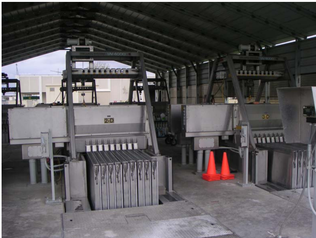
Bild 8: Abwasserdesinfektion durch UV-Bestrahlung im Klärwerk Santa Rosa
