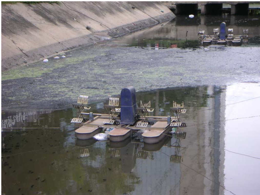
Bild 3: Belüftungseinrichtung in einem Entwässerungsgraben
