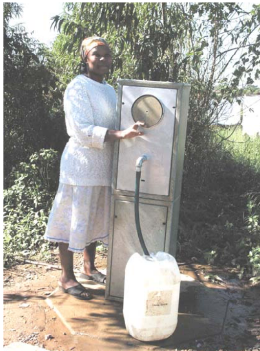
Bild 6: Zapfstelle zur Frischwasserversorgung von mehreren Wohneinheiten im Umkreis von 1 000 m
