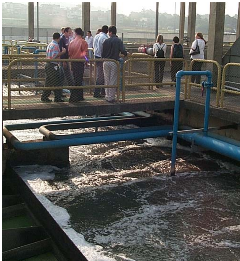
Bild 8: Belebungsbecken mit Tiefenbelüftung der Kläranlage ETE ABC
