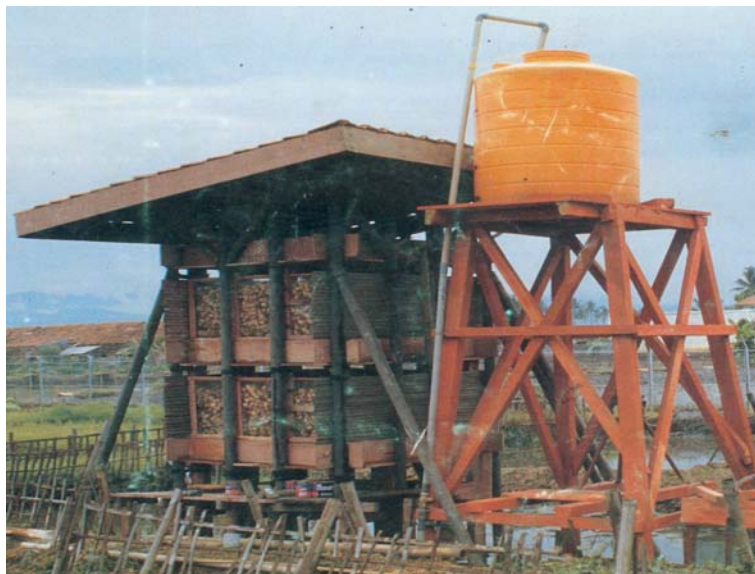
Bild 24: Schwachbelasteter Bambustropfkörper zur Vorbehandlung von häuslichem Abwasser (BMBF-Projekt 02WA414)
