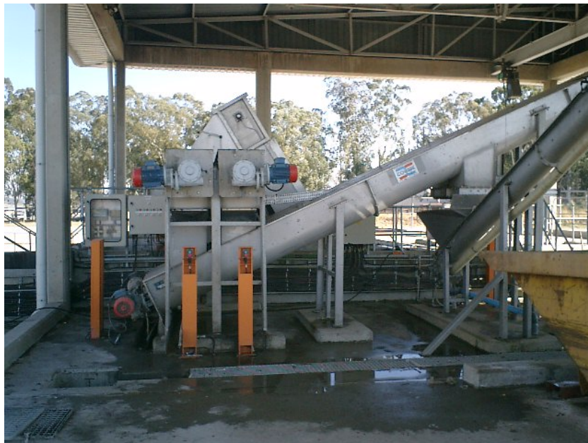
Bild 16: Rückseite eines Kletter-Rechens ("Step Screen"), Nachbau (südeuropäische Fertigung). Betriebsprobleme aufgrund von Konstruktions- und Qualitätsmängeln mussten mit hohem Aufwand nachträglich behoben werden.
