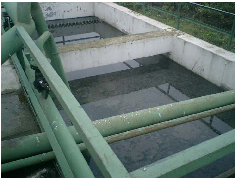
Bild 17: Blick über die Sedimentationskammer (trichterförmiges Absetzbecken mit Lamellenklär-Einbauten, diese sind nicht erkennbar)
