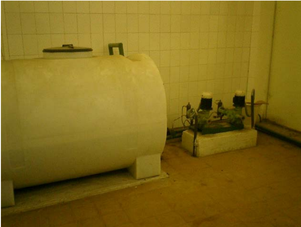
Bild 19: Hypochlorid-Tank zur Abwasserdesinfektion (wird nur bei Niedrigwasser und während der Badeperiode eingesetzt)
