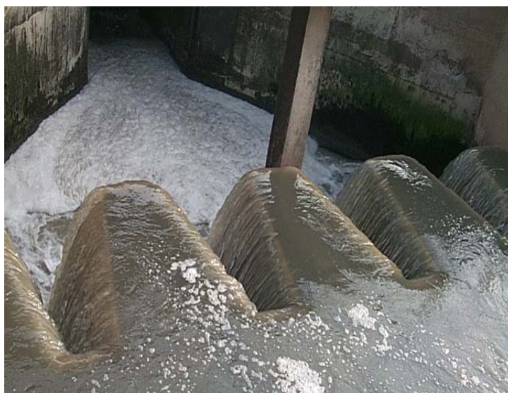
Bild 10: Problem der Schaumbildung: ETE ABC
