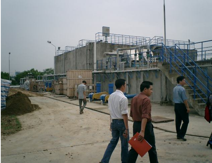
Bild 6: Blick auf eine hochgestellte Kompaktkläranlage (Belebungsbecken)
