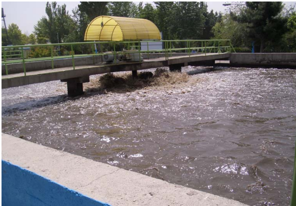
Bild 11: Kläranlage Tehran Shosh: Rechteckiges Belebungsbecken mit Oberflächenbelüfter
