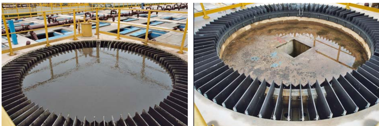
Bild 13: RALF, Kläranlage Curitiba
