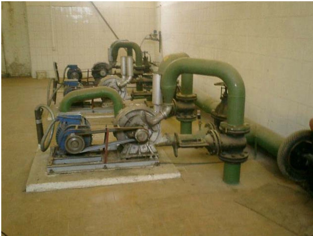
Bild 16: Pumpen für die Airlift-Anlage (das Belebungsbecken arbeitet ohne konventionelle Gebläse). Diese Ausrüstung ist vergleichbar der alten "Zarnack"-Technik, nicht jedoch die Beckenbauweise.
