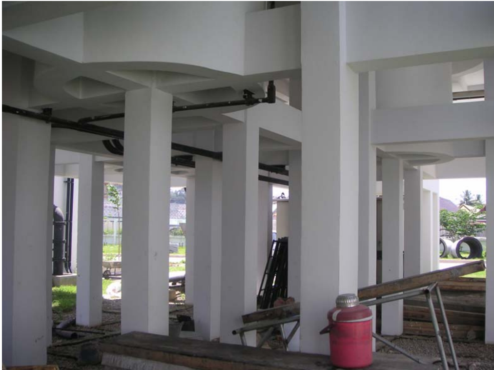
Bild 6: Aufgeständerter Rundsandfang mit mehreren Kammern (Vortex-Typ, Ansicht von unten)
