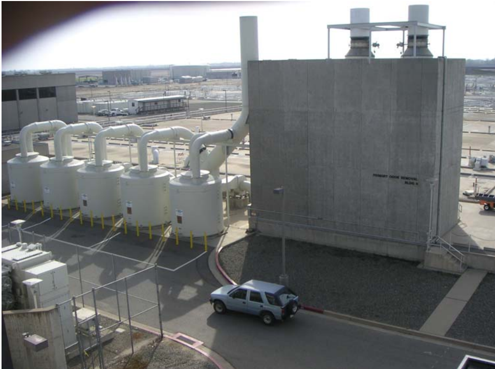
Bild 5: Klärwerk Sacramento, Vordergrund: Abluftreinigungsanlage der mechanischen Stufe, Hintergrund: Abgedeckte Vorklärbecken
