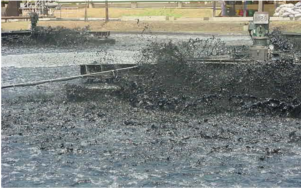
Bild 7: Belebungsbecken mit Oberflächenbelüfter
