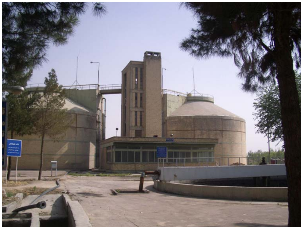
Bild 28: Esfahan, Kläranlage Nord: Faultürme
