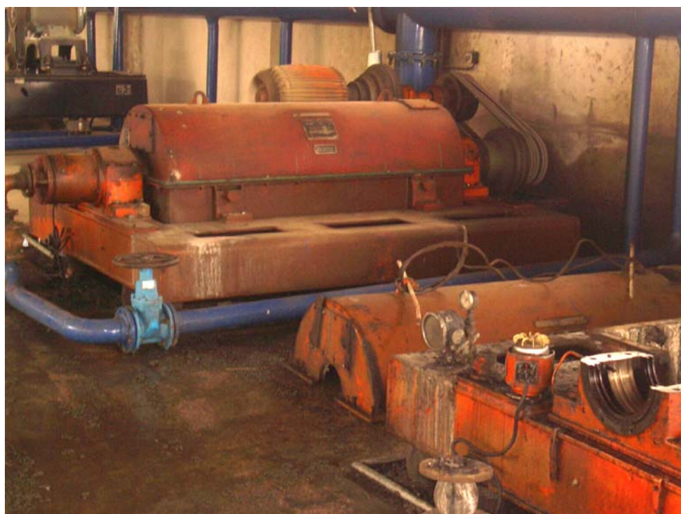
Bild 26: Esfahan, Kläranlage Süd: KHD-Zentrifugen
