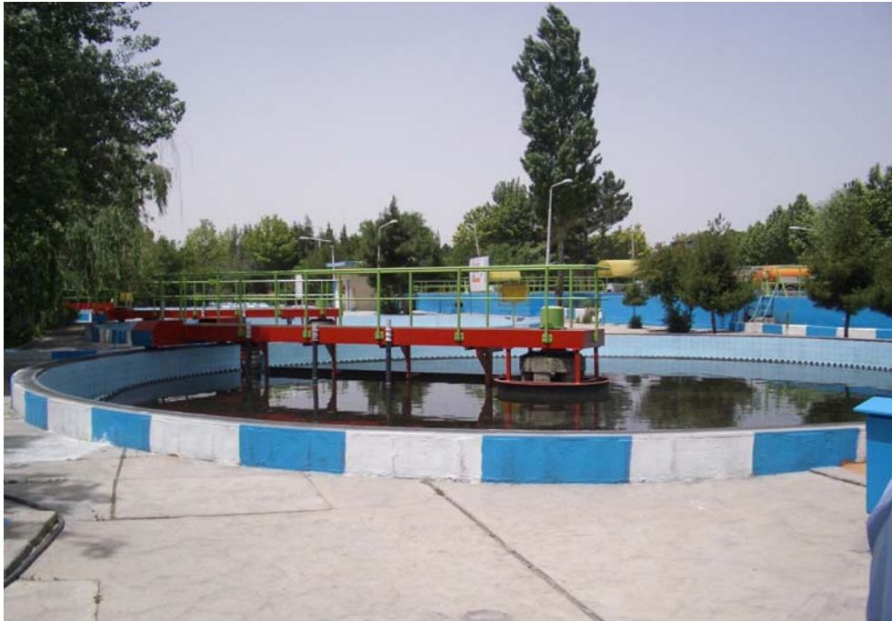
Bild 12: Kläranlage Tehran Shosh: Nachklärbecken
