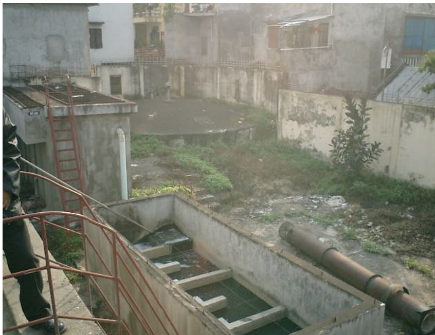
Bild 8: Blick von der Ablaufseite her über ein Kompaktklärwerk. Im Vordergrund die Chlorstufe, im Hintergrund die Belebung/Nachklärung.
