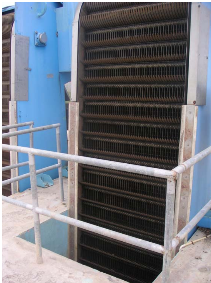
Bild 5: Siebanlage im Klärwerk 2 in Hua Hin
