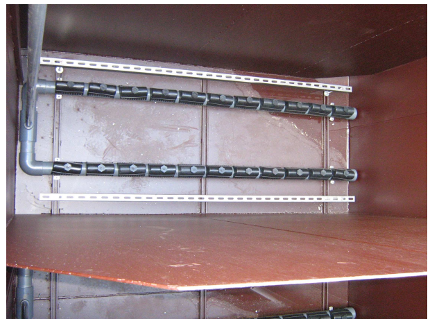
Abbildung 4.2.2: Blick auf das Belüftersystem in einer Reaktorkammer vor der Befüllung mit den Festbett-Füllkörpern
