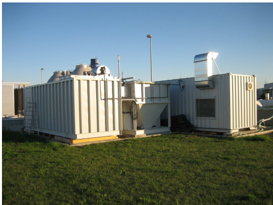
Abbildung 4.5.1: Gesamtansicht der Containeranlage. Hinten: Messcontainer der MLU. Die beiden Container im Vordergrund zeigen die Rückseite der GEA 2H Water Technologies-Versuchsanlage
