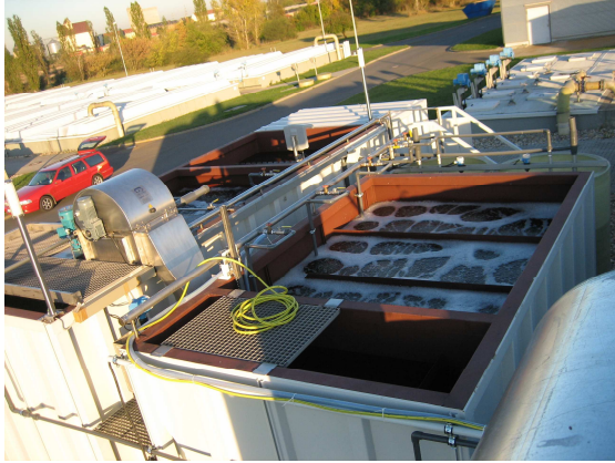
Abbildung 4.5.3: Sicht auf die Containeranlage. Im vorderen Behälter sind die drei Nitrifikationskaskaden zu erkennen
