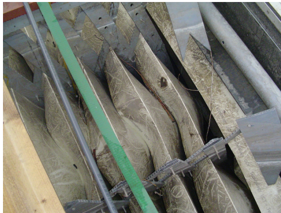
Abbildung 9: Durch Gasakkumulation gebeulter Dreiphasenabscheider
