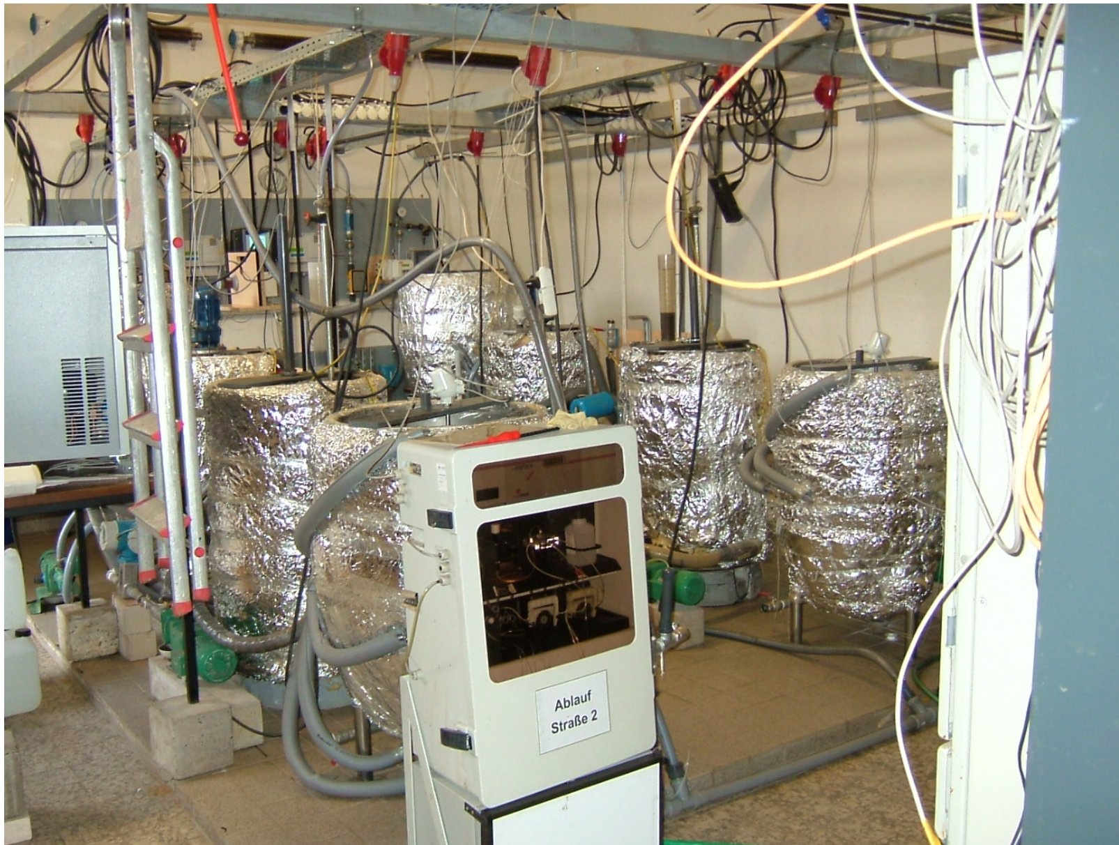
Abbildung 6b: Gesamtansicht der Versuchskläranlage (Belebungsverfahren) der RU Bochum.
