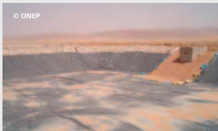
Bassin de la station de Bouarfa-Maroc, de type anaérobie, étanché par une géomembrane.
