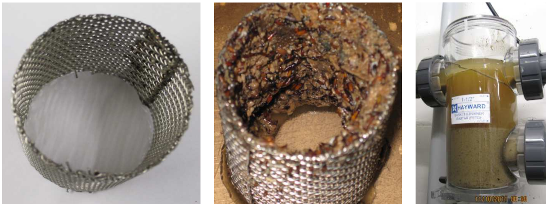
Abbildung 46: Vor dem MAP-Fällungsreaktor eingebauter Schmutzfang. Links: gereinigter (alter; Mitte: belegter alter Schrägsitzschmutzfang mit den länglichen, gelblich bis dunkelbraunen Larvenhüllen; Rechts: befüllter Siebkorb mit abgeschiedenen Fällprodukten im Bodensatz.
