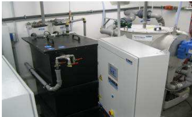
Abbildung 32: Braunwasser-MBR (von links: Membranbioreaktor, Schaltschrank und Braunwasservorreinigung).
