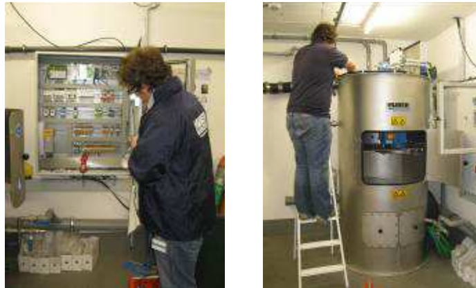
Abbildung 34: Links: Messung der Stromaufnahme am Schaltschrank der Urinbehandlung; Rechts: Wartungsarbeiten am Fällungsreaktor.
